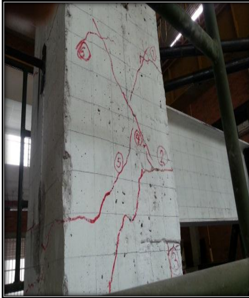
Figura 28. Detalle de fisuras en el costado izquierdo de la columna.
