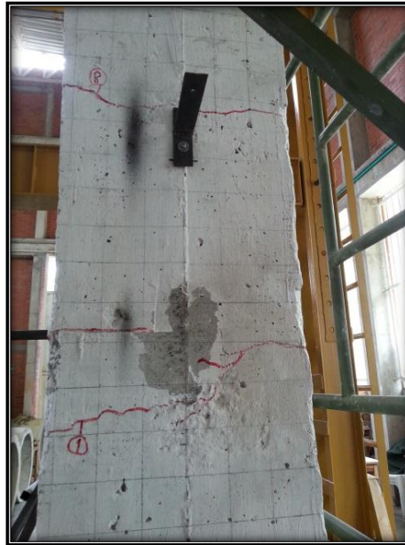
Figura 30. Detalle de fisuras en la parte posterior de la columna.
