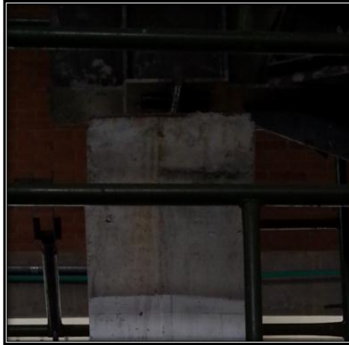
Figura 25. Detalle del apoyo superior después de la prueba.
