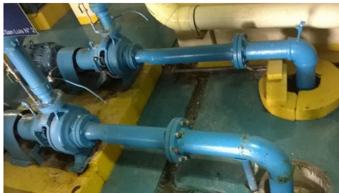
Figura 7. Sistema de bombeo San Luis
