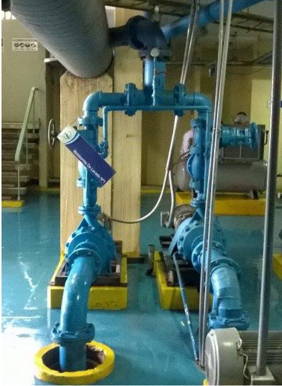
Figura 3. Sistema de bombeo de lavado de filtros
