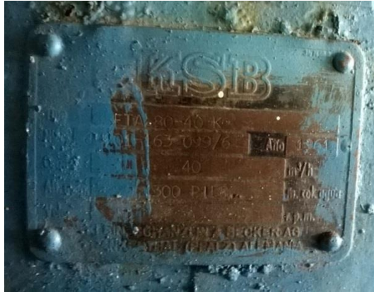
Figura 13. Placa de bomba Lavado 2
