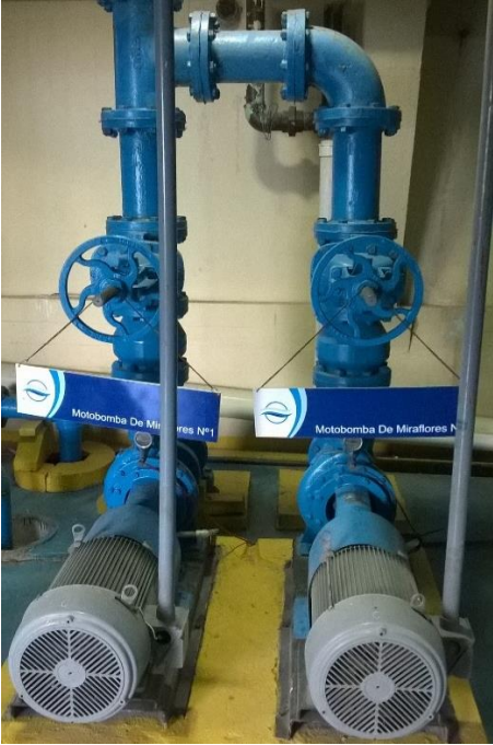
Figura 10. Sistema de bombeo Miraflores
