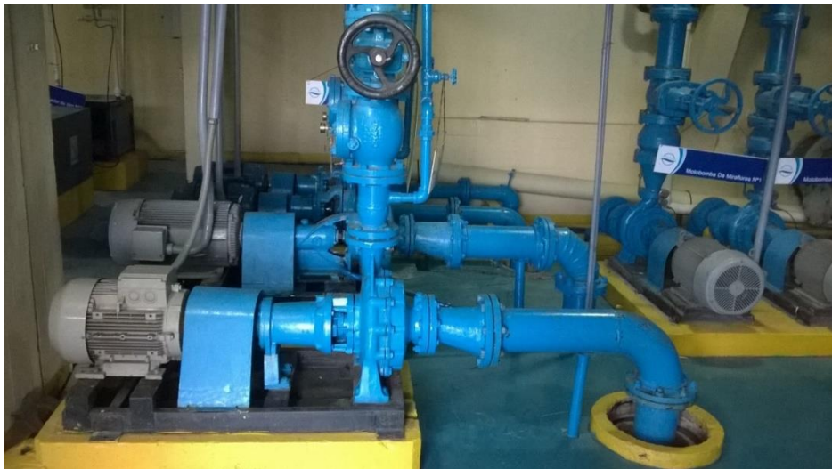
Figura 12. Sistema de bombeo de Lavado
