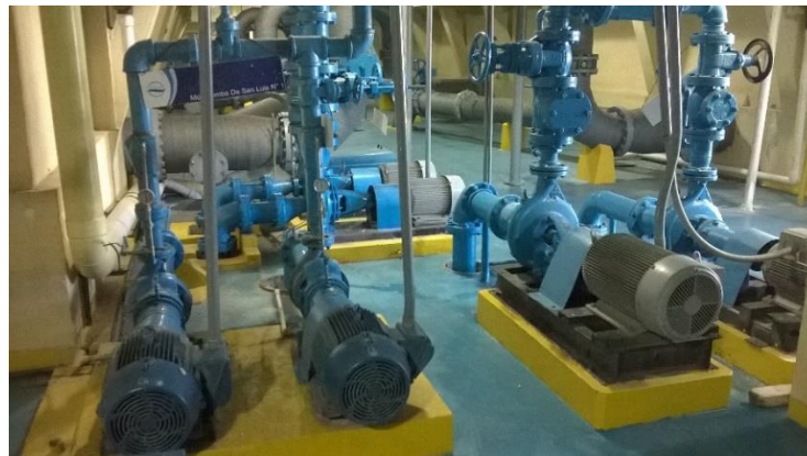
Figura 2. Sistemas de bombeo
