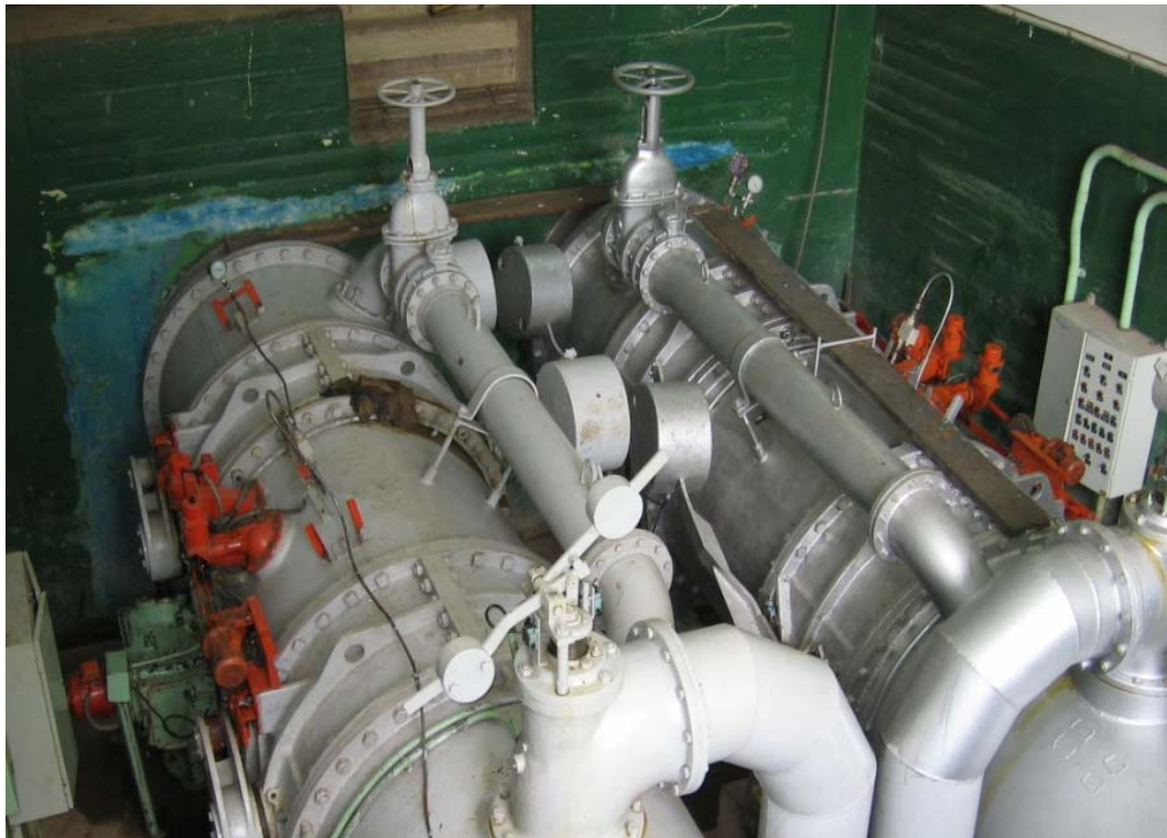
Figura 5. Válvula de Regulación de la entrada de agua a las Turbogeneradoras
