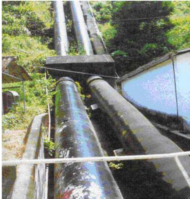
Figura 6. Tubería de Carga
