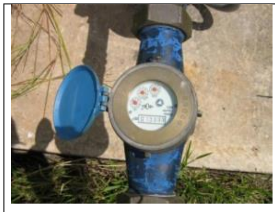
Figura 7. Medidor de flujo
