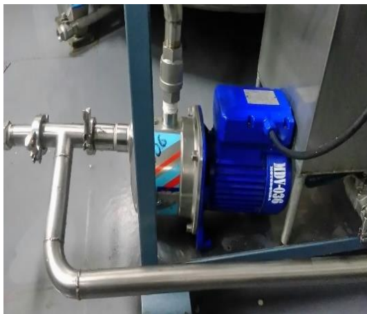
Figura 14. Bomba del filtro prensa
