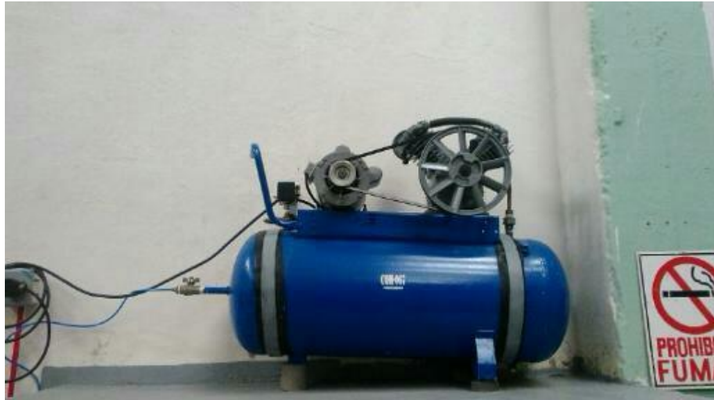
Figura 20. Vista del compresor.
