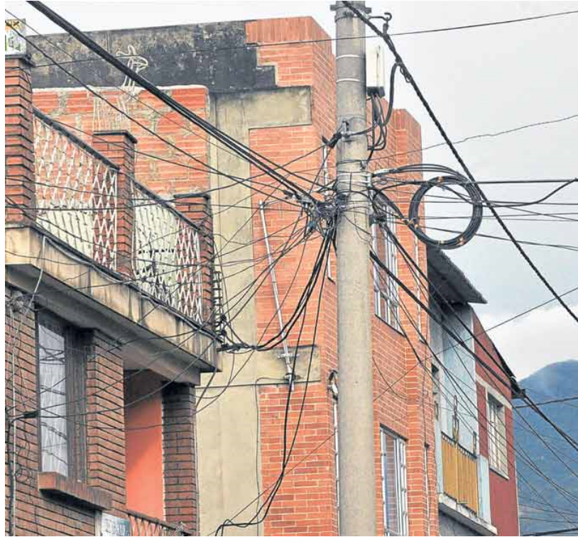
Figura 5: Cableado desordenado, Levantamiento analizado para el programa de Distribuciones Eléctricas.
