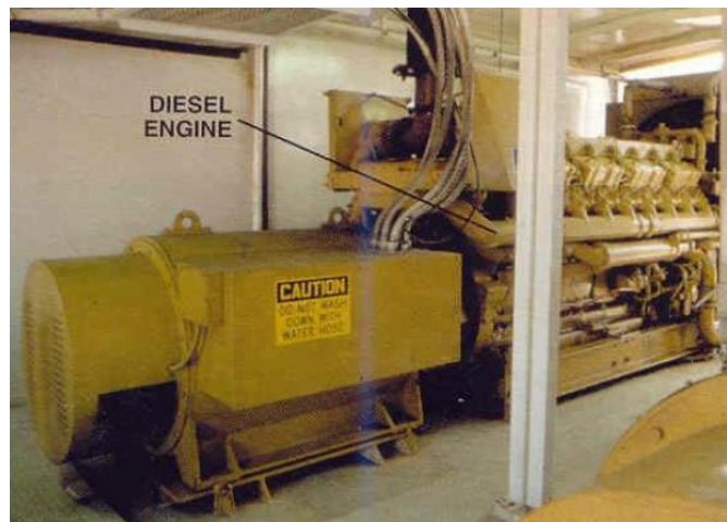
Figura 7. Sistema de potencia.
