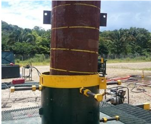
Figura 22. Pérdida de verticalidad ocasionada por presencia de conglomerados.
