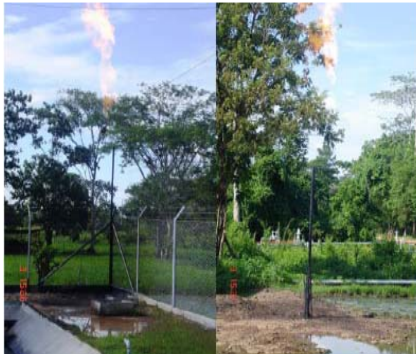
Figura 33. Teas en la Estación Auxiliar.
