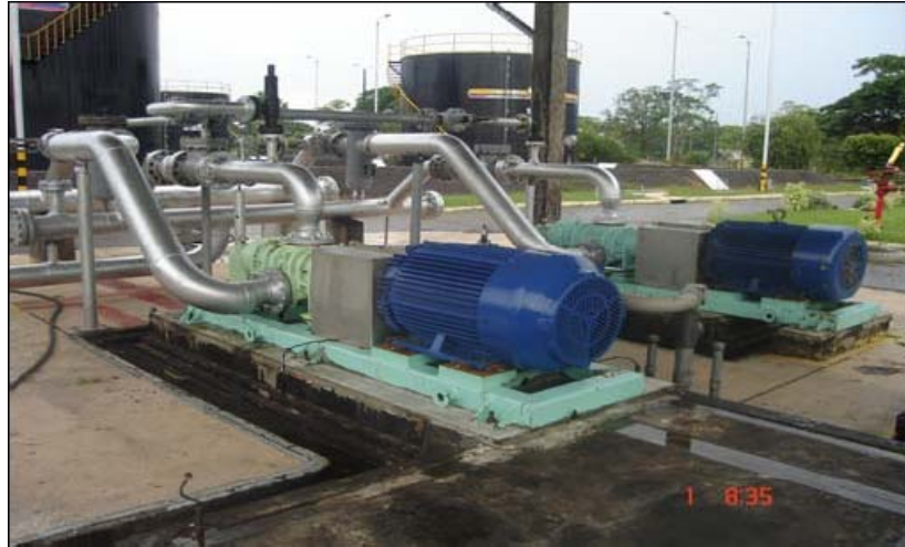
Figura 31. Sistema de bombeo
