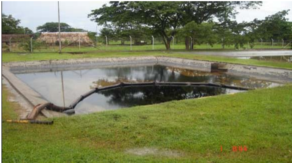
Figura 37. Piscina de Retención.
