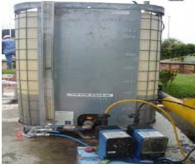
Figura 35. Sistema de Inyección de Químico.
