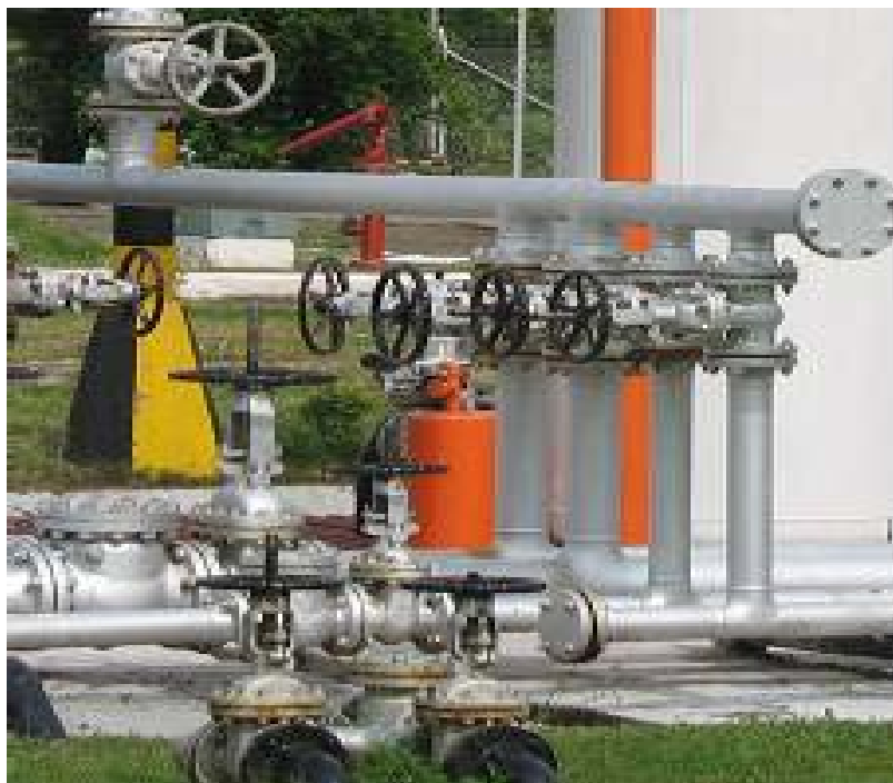
Figura 26. Múltiple de Prueba
