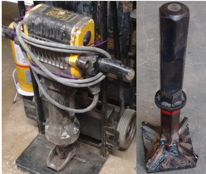
Figura 17. Equipo compactador, consta de un taladro demoledor de 31 Kg y una punta arreglada para este procedimiento.
