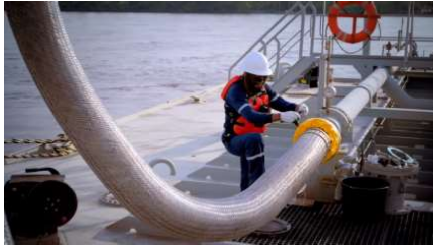
Figura 3. Línea de tubería en el puerto multimodal Barrancabermeja.
