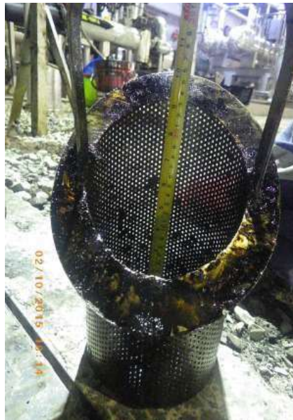
Figura 4. Filtro de la fase de descargue
