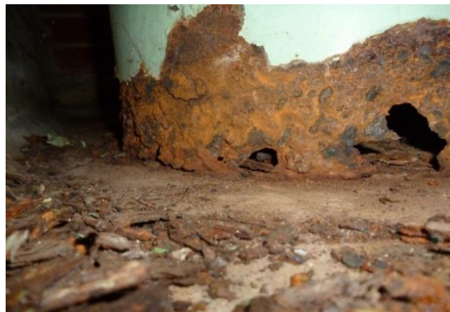
Figura 29. Corrosión en la base del suavizador.
