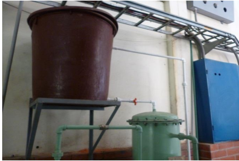
Figura 35. Conexión tanque de salmuera
