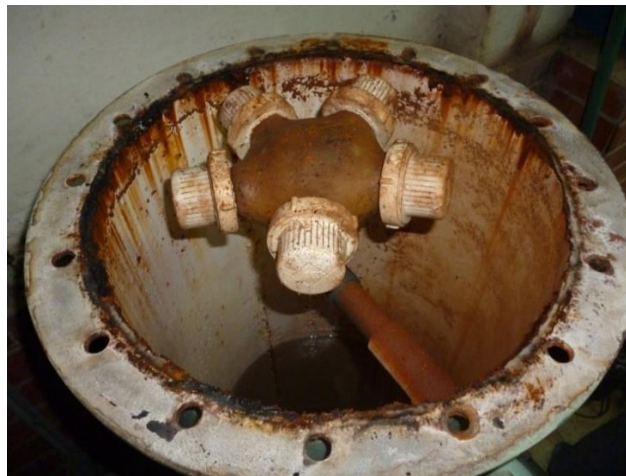
Figura 31. Interior del suavizador.
