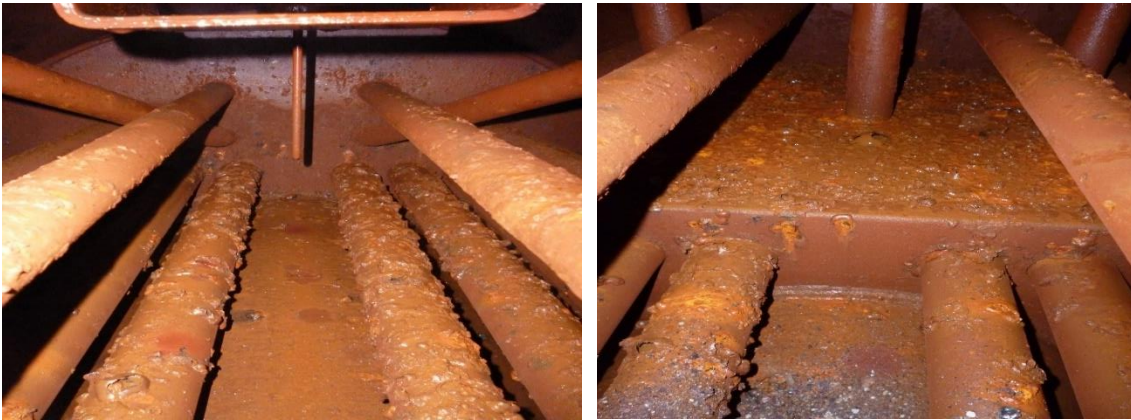
Figura 59. Detalle superficie tubos.
