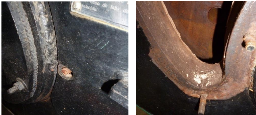
Figura 54. Detalle pernos y suciedad en compuerta frontal.
