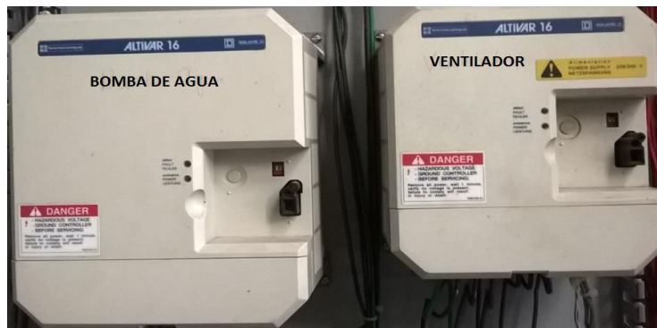
Figura 28. Variadores de frecuencia.
