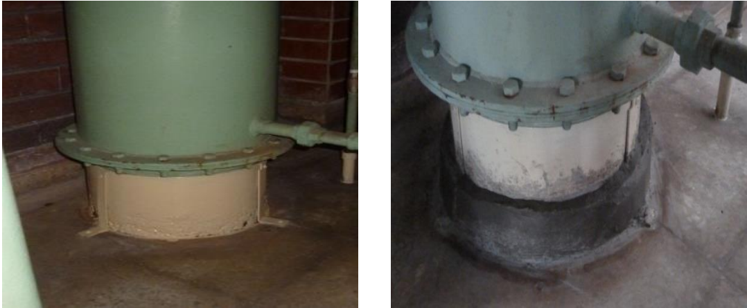
Figura 30. Pintura y protección en la base del suavizador.
