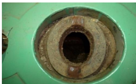
Figura 56. Detalle orificio de inspección Hand Hole.
