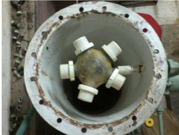
Figura 32. Interior del suavizador limpio.
