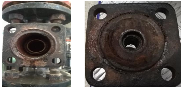
Figura 70. Detalle del estado de la válvula.
