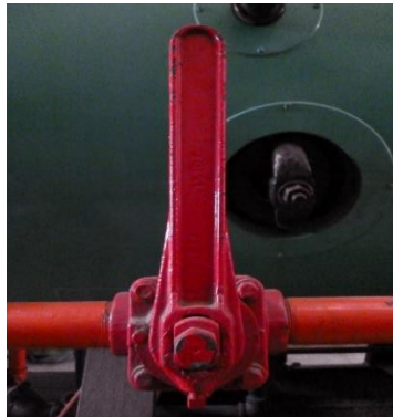
Figura 13. Válvula manual para gas
