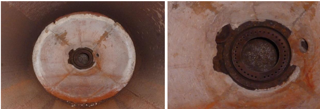
Figura 50. Detalle quemador parte interna.
