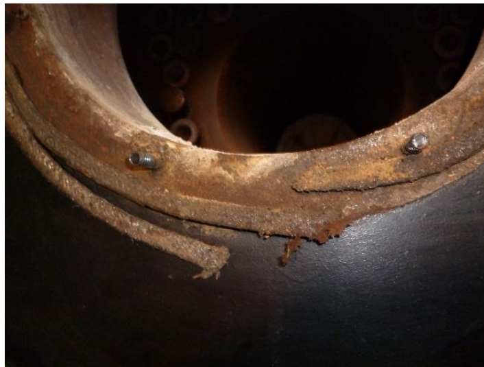
Figura 48. Detalle cordón de asbesto.
