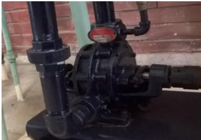
Figura 46. Bomba armada y con mantenimiento realizado.
