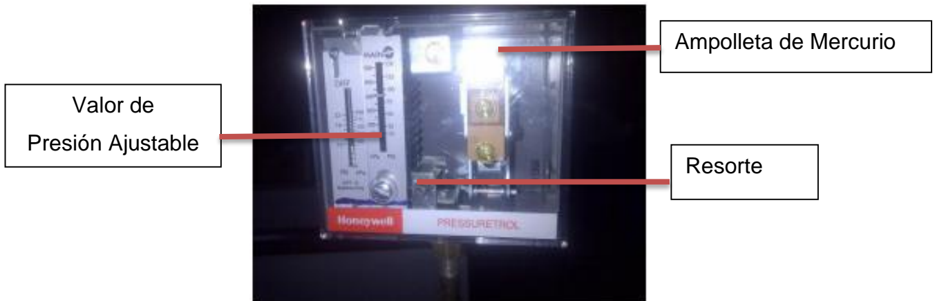
Figura 24. Presóstato de operación.
