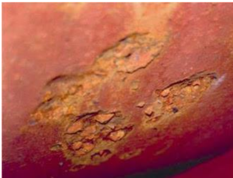
Figura 68. Picadura en los tubos.
