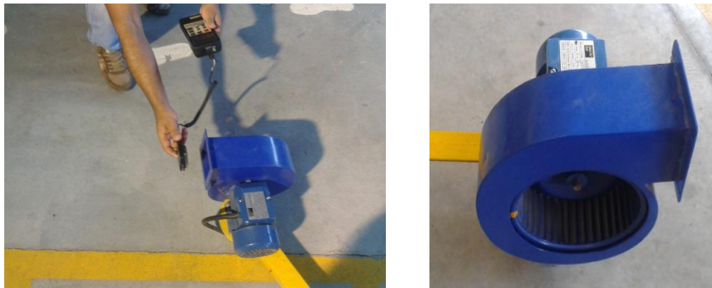
Figura 69. Mediciones de velocidad del aire en la descarga de los ventiladores
