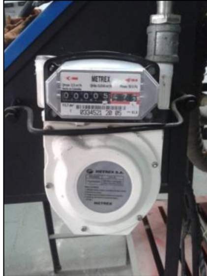
Figura 76. Medidor de flujo de gas.
