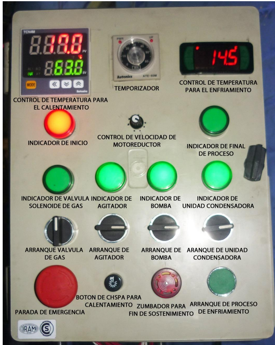
Figura 75. Tablero de control
