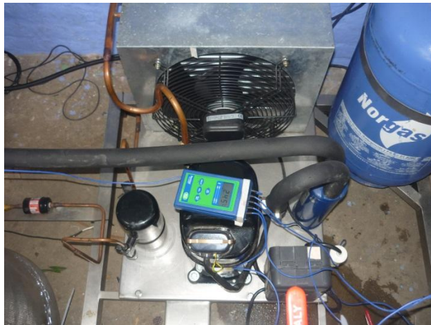
Figura 74. Unidad condensadora y Penta III
