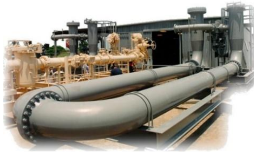
Figura 12. Probador Instalado en campo.
