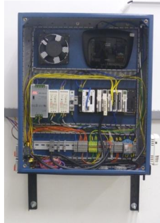
Figura 54. Plataforma de Adquisición de Datos y Control
