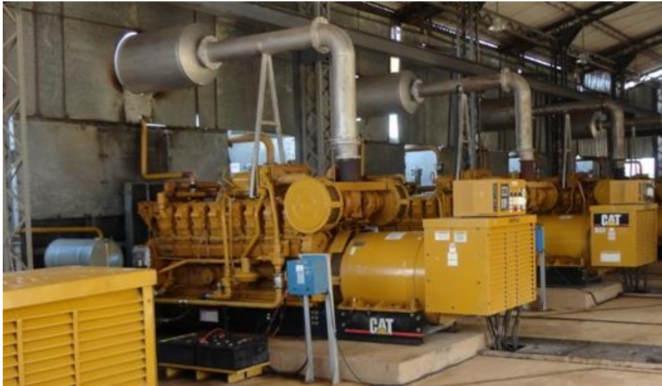
Figura 11. Generador Carterpillar Campo Trinidad
