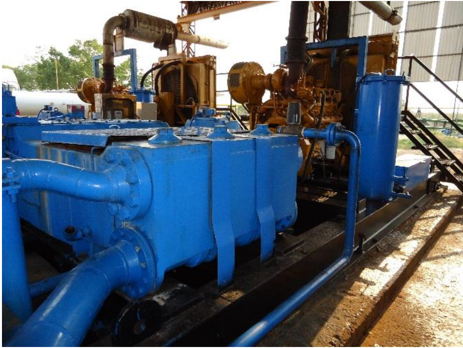
Figura 9. Motobomba National J375- Campo Trinidad
