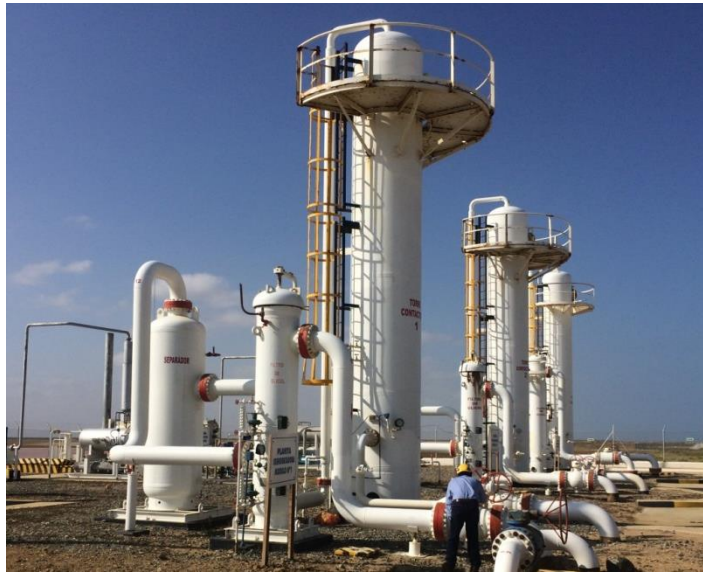
Figura 6. Tren de deshidratación - Ballena
