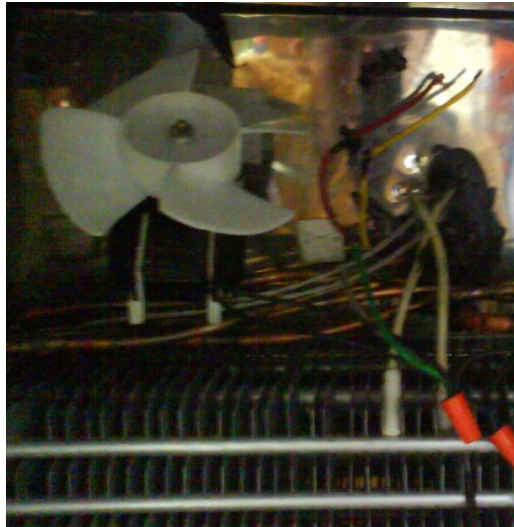
Figura 85. Ventilador del evaporador.
