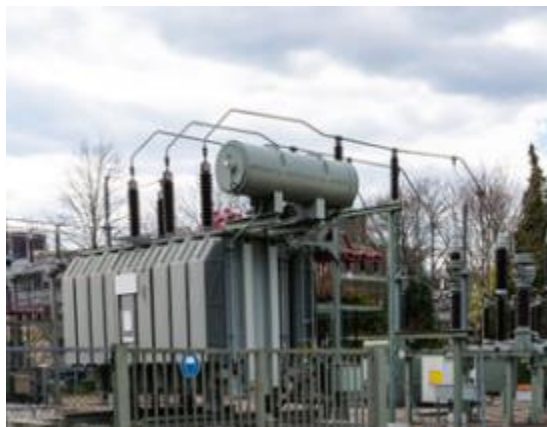
Figura 22. Tanque de transformador de potencia
