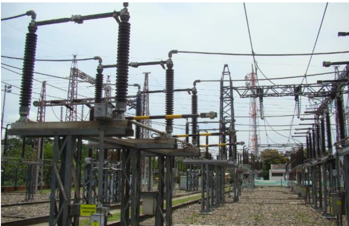
Figura 25. Seccionador en una subestación eléctrica
