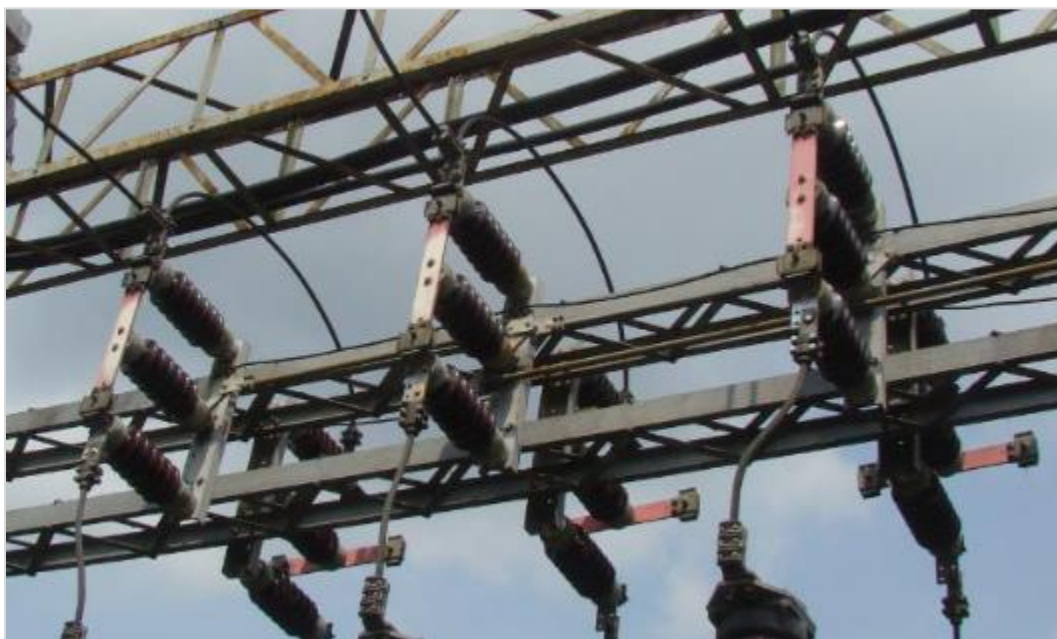
Figura 27. Subestación de maniobra
