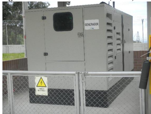
Figura 27 Generador eléctrico. (Autor)
