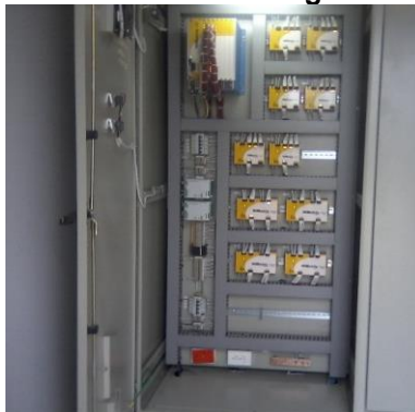
Figura 29 Gabinete de sistema de emergencia ESD. (Autor).
