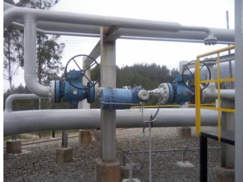
Figura 11 Válvula de recirculación PV-200. (Autor).
