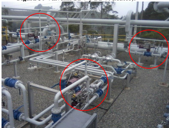
Figura 30 Válvulas SDV y BDV. (Autor).
