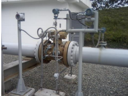
Figura 10 Medidor de flujo de succión FIT-200. (Autor).
