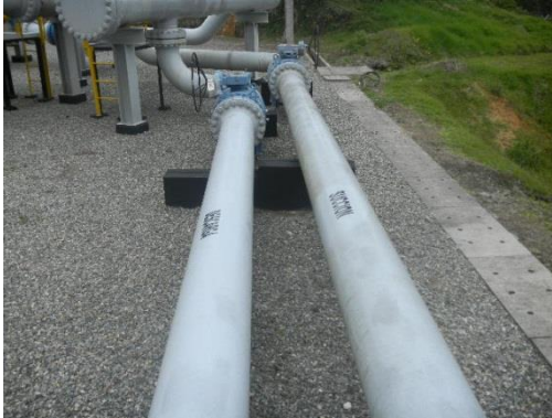
Figura 2 Cabezal de succión y descarga de estación (Autor)
