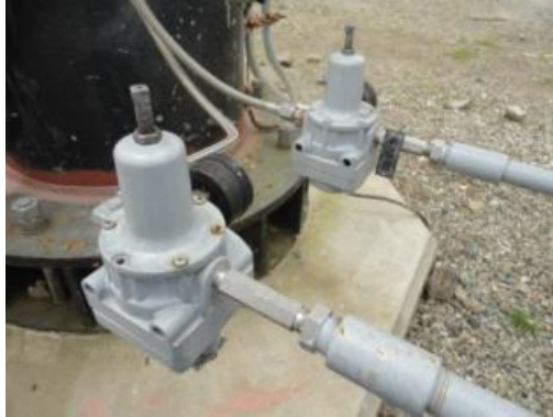
Figura 23 Regulación de gas piloto de tea (Autor)
