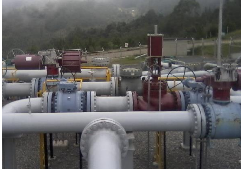
Figura 4 Válvula reguladora de estación PV-100 (Autor)
