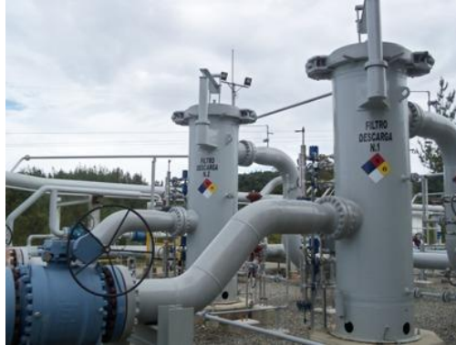
Figura 9 Filtros de descarga FD-001/002. (Autor).
