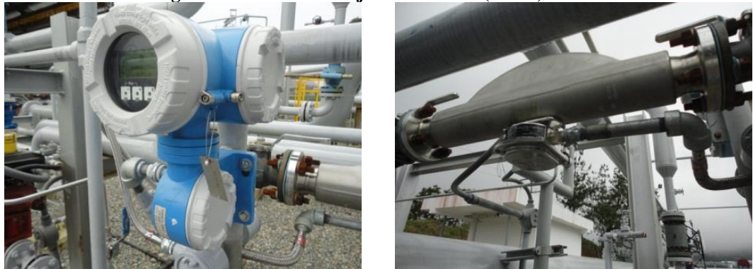
Figura 19 Medidor de flujo FE/FIT-300. (Autor).
