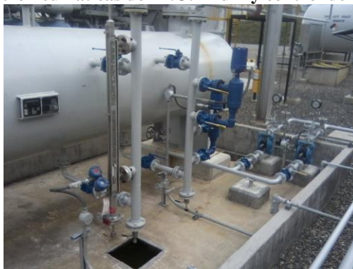
Figura 38 Bombas electro neumáticas del K.O. Drum y control de líquidos. (Autor).
