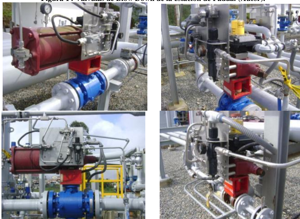
Figura 14 Válvulas de Blow Down de la estación de Padua. (Autor).
