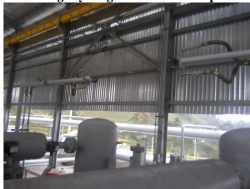
Figura 32 Detectores de gas y fuego en zona de compresión. (Autor)
