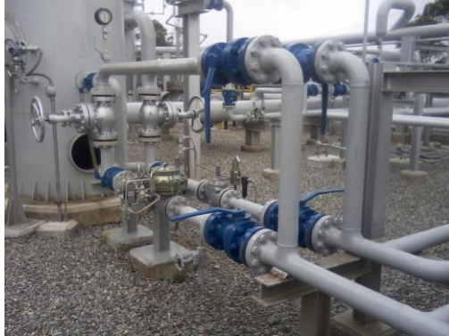
Figura 20 Tambor y reguladores de gas de arranque. (Autor).
