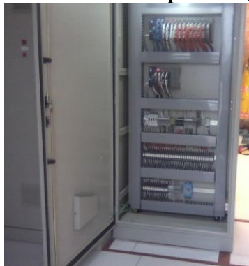
Figura 28 Gabinete de control de procesos. (Autor).
