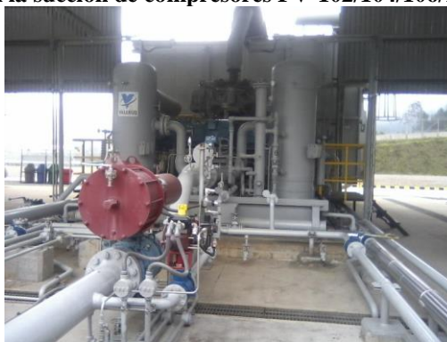
Figura 36 Válvulas en la succión de compresores FV-102/104/106/108/110. (Autor)
