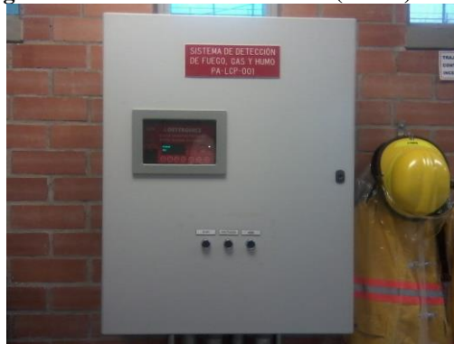
Figura 31 Gabinete sistema F&G. (Autor).
