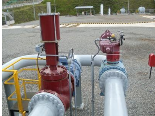
Figura 33 Válvula PV-100(Izq.) y FV-100(Der.). (Autor)
