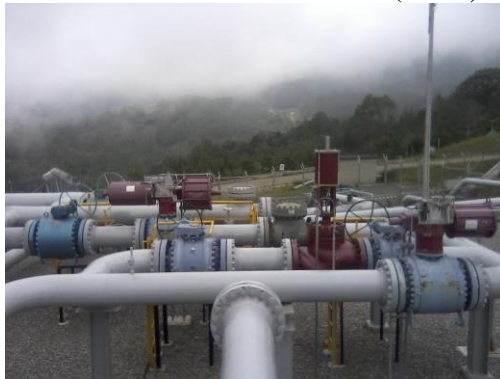
Figura 3 Manifold de succión de estación (Autor)
