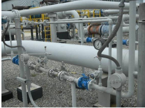
Figura 21 Regulación de gas piloto y purga de tea. (Autor)
