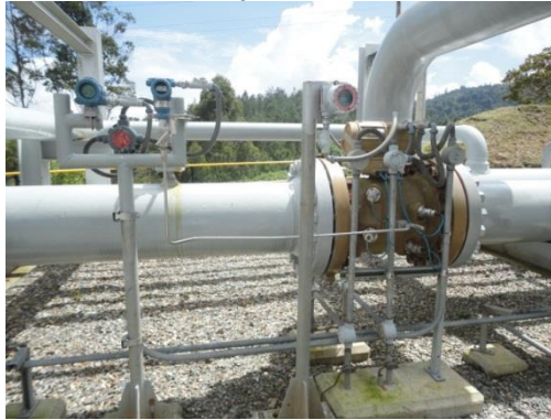
Figura 7 Medidor de flujo de succión FIT-100. (Autor).
