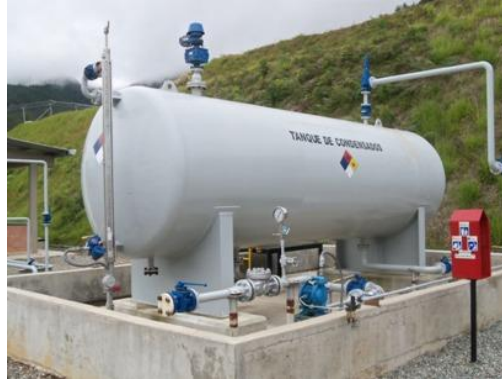
Figura 16 Tambor acumulador de condensados (V-003). (Autor).
