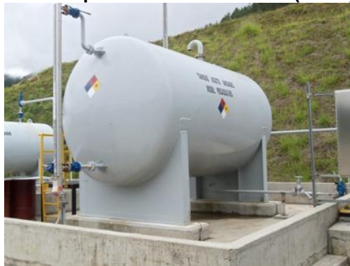
Figura 24 Tanque de aceite lubricante (Autor)
