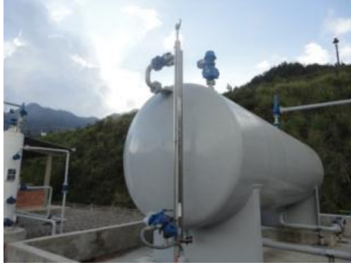
Figura 25 Tanque de condensados (Autor).
