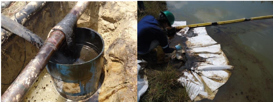
Figura 34. Línea de flujo de pozo Cuerva 10 a Cuerva 6 con presencia de fuga.
