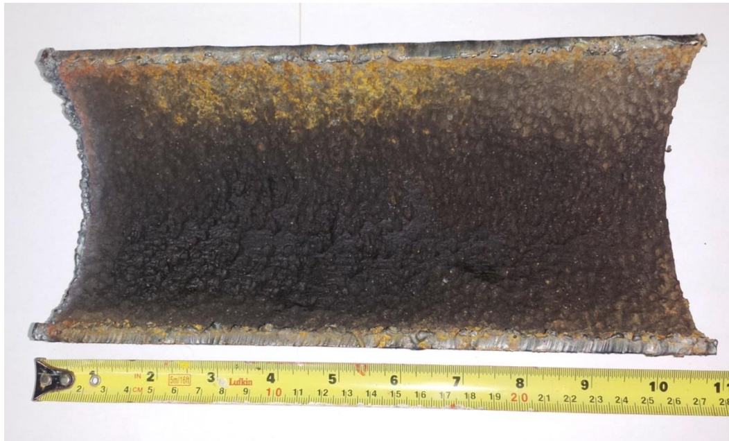
Figura 64. Sección interna de tubería corroída API 5CT tamaño 4 ½ 12.75#.
