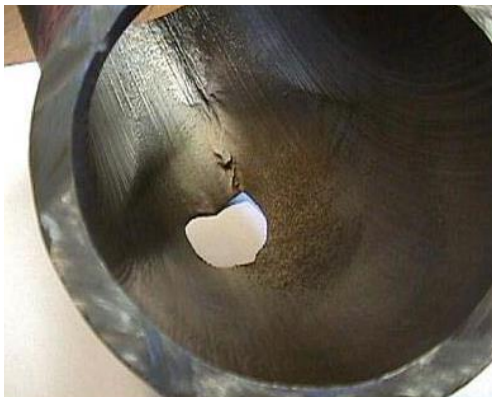
Figura 21. Erosión presentada en un codo
