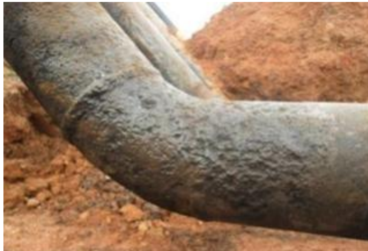
Figura 9. Línea de flujo con corrosión externa
