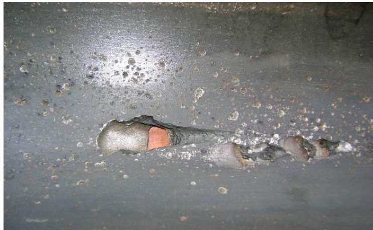
Figura 10. Corrosión interna en tubería de recolección de fluidos de pozo.
