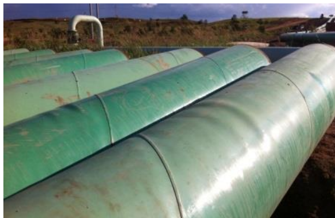
Figura 13. Pandeos generados durante actividades de doblado de tubería
