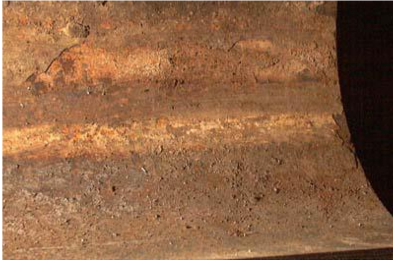
Figura 18. Corrosión generalizada interna en tubería metálica
