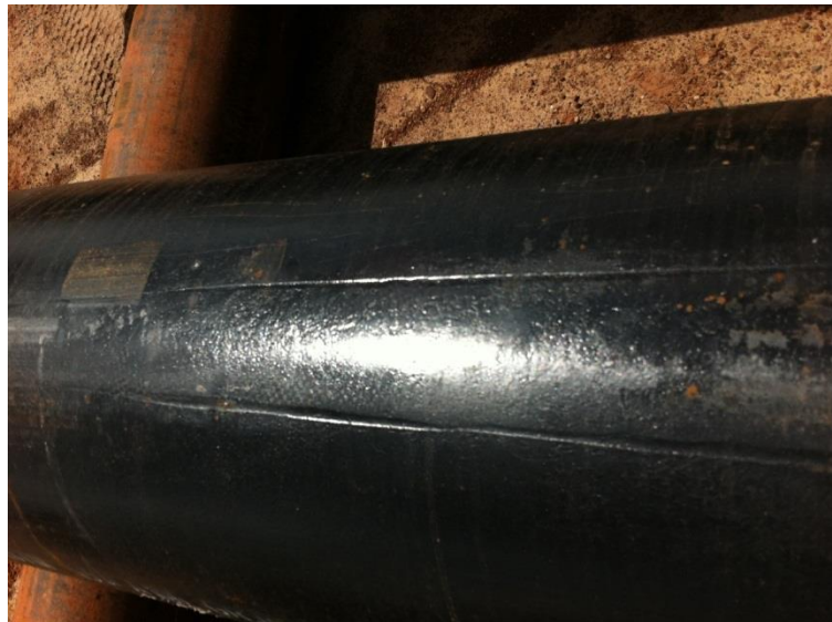
Figura 12. Imperfecciones generadas en el proceso de fabricación de tubería
