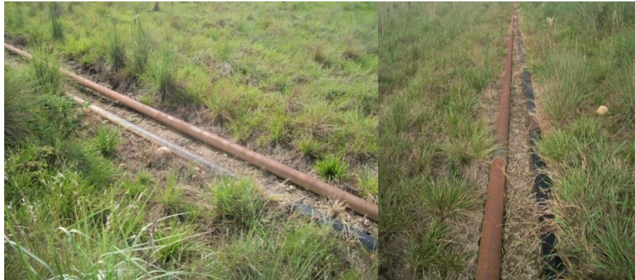
Figura 33. Líneas de flujo típicas instaladas en campo Cuerva
