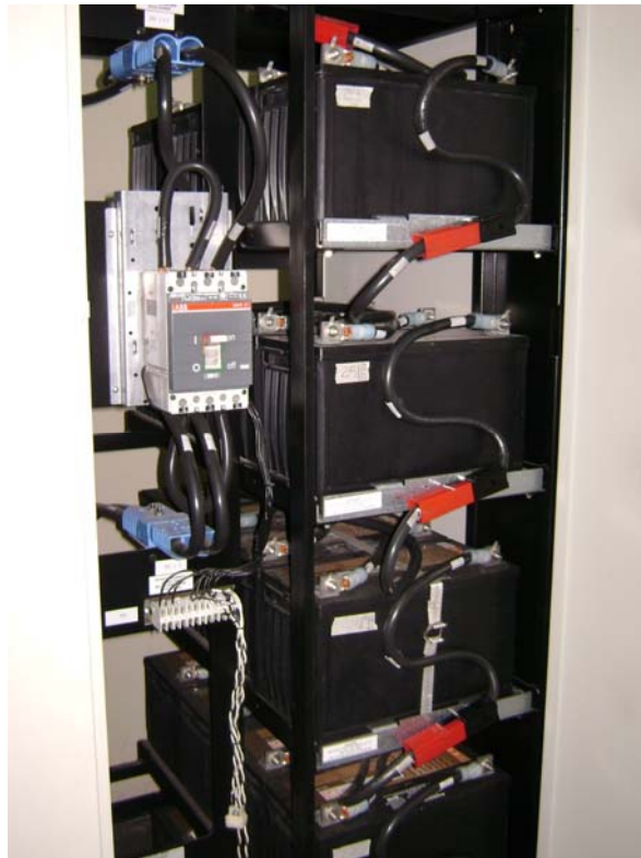
Figura 3.3 Arreglo de baterías en serie
