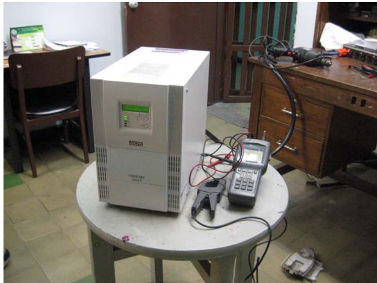
Figura 5.1 Pruebas a la UPS en los talleres de la DMT
