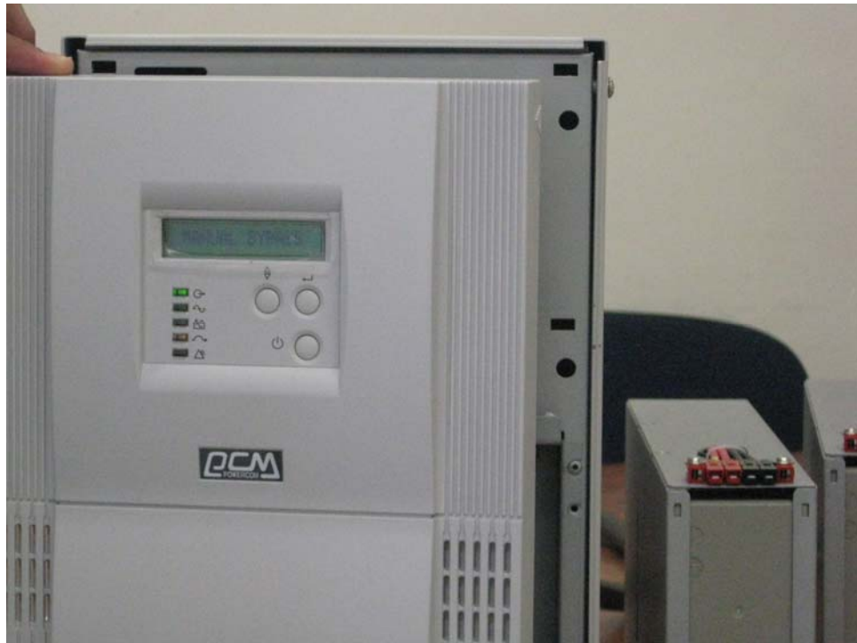
Figura 2.10 UPS en modo bypass de mantenimiento, funcionando sin necesidad de usar las baterías
