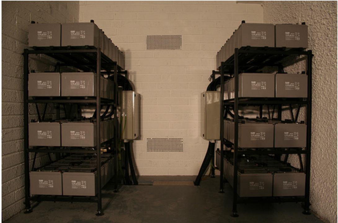
Figura 3.7 Baterías en estantes Fuente: http://farm2.static.flickr.com
