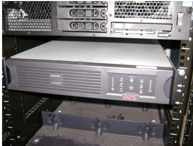
Figura 3.8 Sistema UPS montado en rack
