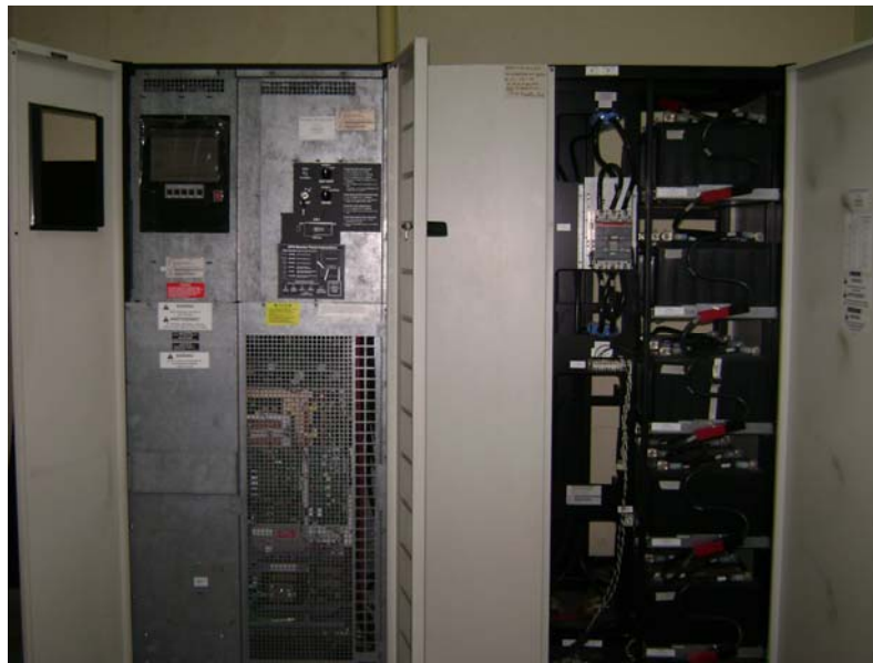
Figura 3.6 Ejemplo de un banco de baterías externo a una UPS de 80kVA. Se aprecia en el lado izquierdo la UPS y en lado derecho el banco de baterías.
