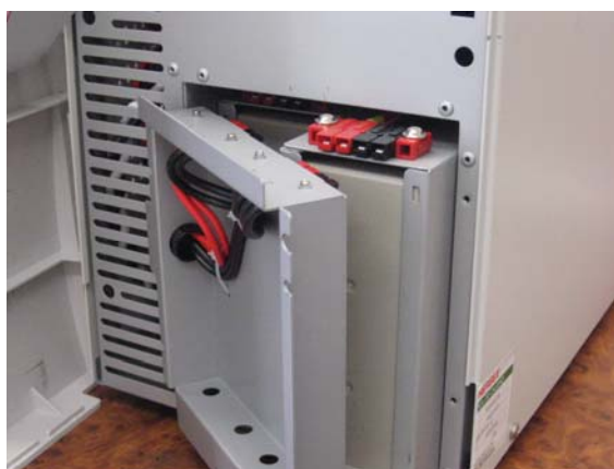
Figura 3.5 Ejemplo de una UPS de 3kVA con un banco de baterías interno
