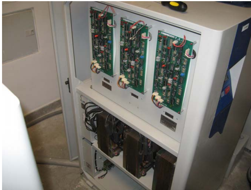
Figura 6.3 UPS PEI de 10kVA que soporta servidores
