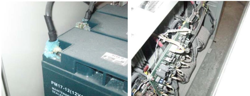
Figura 7.2 Ejemplos de sulfatación y suciedad. Imagen tomada de un mantenimiento preventivo a UPS del CENTIC
