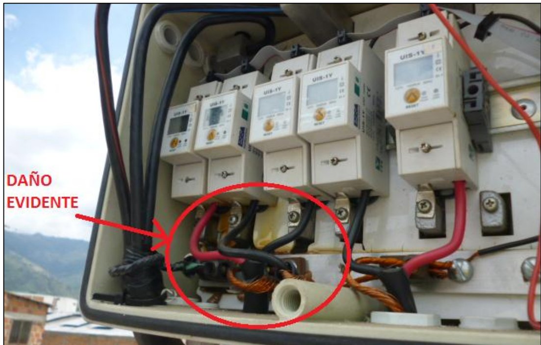
Figura 14. Medidor centralizado Barrio La Feria Piedecuesta posible punto caliente
