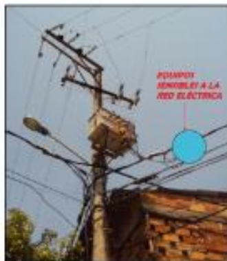
Figura 3. Subestación aérea Jerusalén Barrancabermeja, conexión de equipos sensibles a la red.
