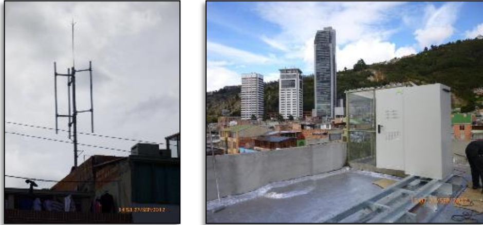
Figura 3. Estaciones base tipo Rooftop
