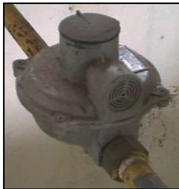
Figura 41 . Válvula Reductora de Gas
