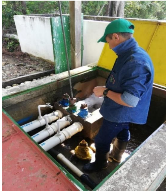
Figura 2. Ingreso fuentes superficiales PTAP principal Málaga
