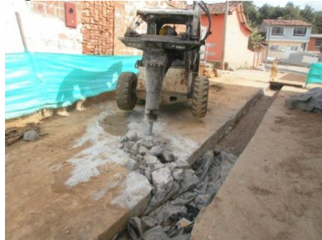
Figura 24: Rotura para domiciliaria
