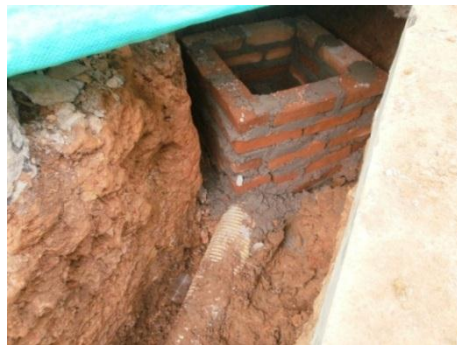
Figura 54: Caja de inspección
