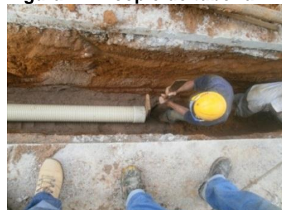
Figura 47: Acople de tubería
