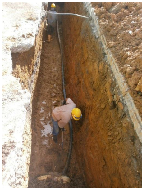
Figura 37: Conducción de aguas
