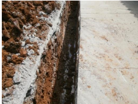
Figura 42: Zanja con desechos
