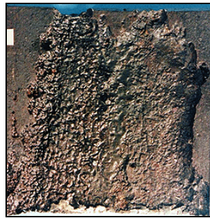
Figura 4. Corrosión por picadura en tuberías
