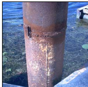
Figura 2. Corrosión uniforme en tuberías Fuente: http://www.corrosion-club.com/images/uniform1.jpg
