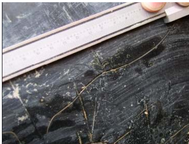
Figura 39. Agrietamiento de revestimiento 3LPE en una tubería de 36''. Fuente: Pipeline integrity using the external corrosion direct assessment (ECDA) methodology: a case study, 8th International Corrosion Conference.
