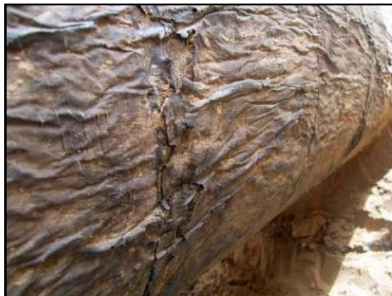
Figura 37. Arrugamiento y embolsamiento del CTE causado por esfuerzos del terreno Fuente: Pipeline integrity using the external corrosion direct assessment (ECDA) methodology: a case study, 8th International Corrosion Conference.
