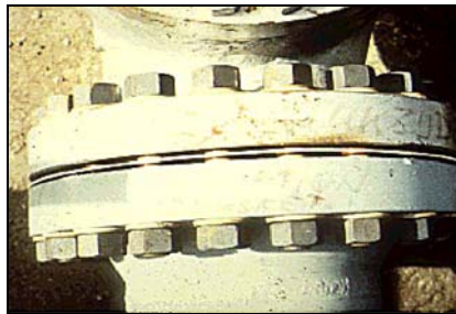
Figura 5. Corrosión por hendiduras. Fuente: http://corrosion.ksc.nasa.gov/corr_forms.htm
