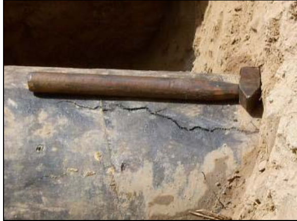
Figura 36. Agrietamiento en la parte superior del CTE causado por esfuerzos del terreno Fuente: Pipeline integrity using the external corrosion direct assessment (ECDA) methodology: a case study, 8th International Corrosion Conference.
