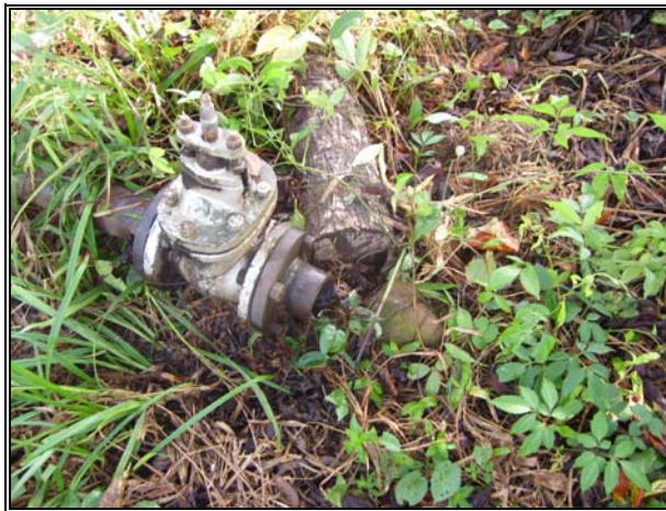
Figura 40. Daños por terceros. Hurto de tubería. Fuente: Los autores
