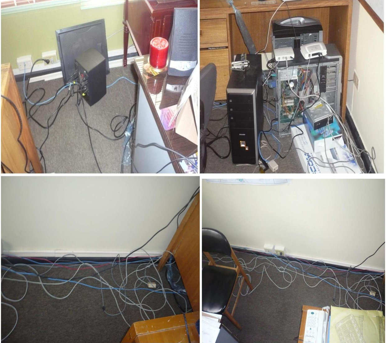
Figura 21. Instalaciones de cableado antiguas
