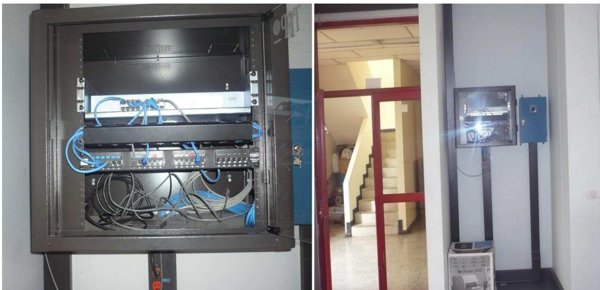
Figura 20. Rack del departamento de Sistemas
