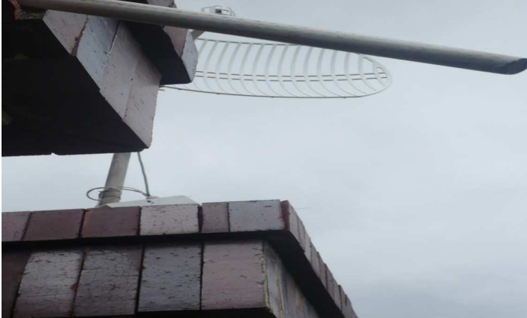
Figura 11. Antena en Oficina Cómbita
