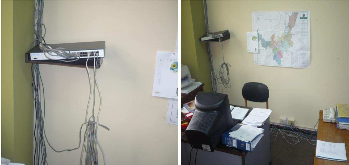
Figura 19. Patch panel con el que se contaba en el departamento de Sistemas
