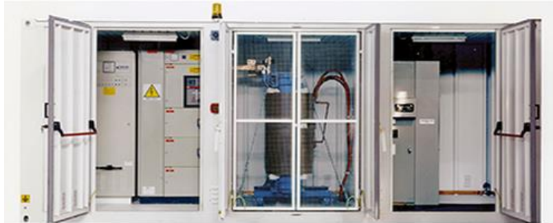
Figura 14 Tablero de control eléctrico ESSI S.A.S.
