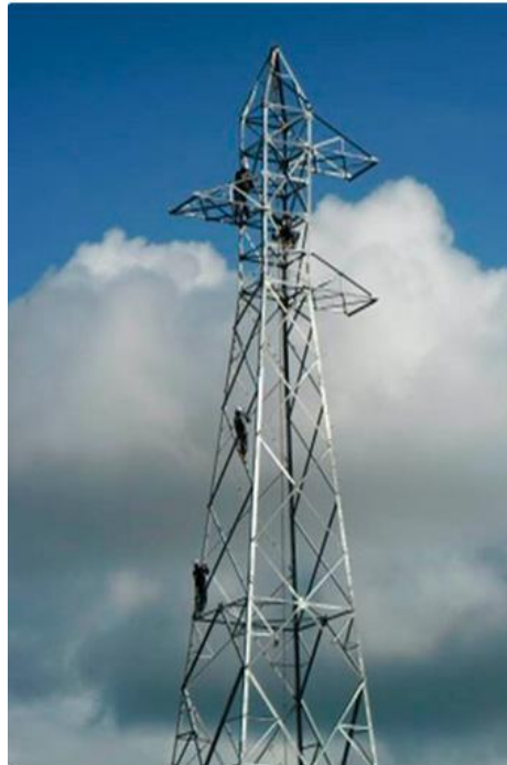
Figura 11 Torre eléctrica ESSI S.A.S.
