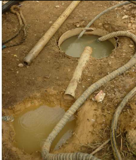
Fotografía N. 9 Sistema de sedimentación usado para la máquina.
