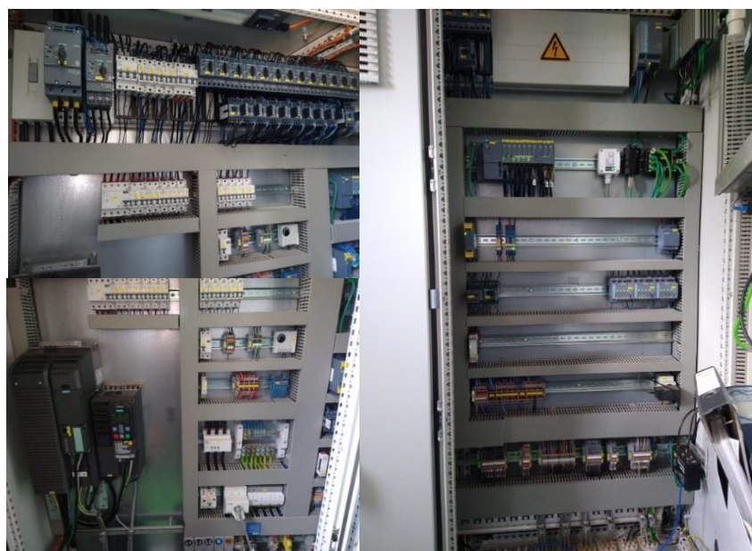
Gabinete eléctrico sala de máquinas
