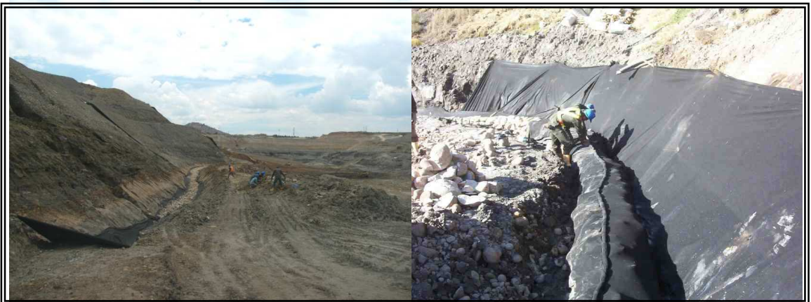
Fotografía 14. Construcción filtro en roca sobre pata de un talud. Sellado y cosido del filtro.
