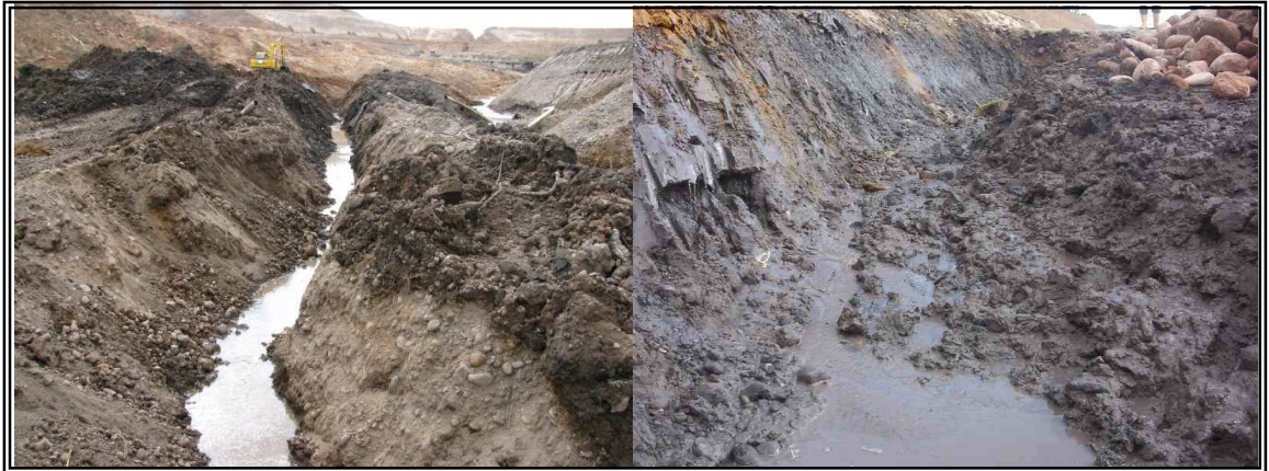
Fotografía 12. Canalización y evacuación de aguas que aparecieron en el flanco derecho del deslizamiento
