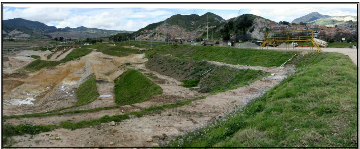
Fotografía 19. Aspecto de la revegetalización en taludes superiores finales reconfigurados del talud Codeipa
