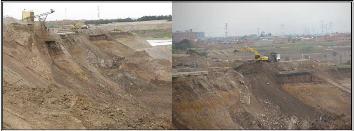
Fotografía 8. Descabece en la parte alta de la corona del deslizamiento.
