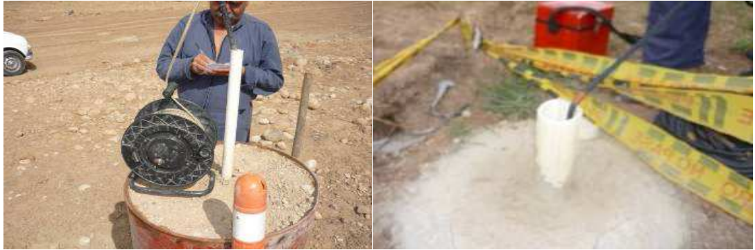
Fotografía 25. Inclinómetros. Monitoreo en inclinómetros 3 y 4 en el talud de Codeipa.
