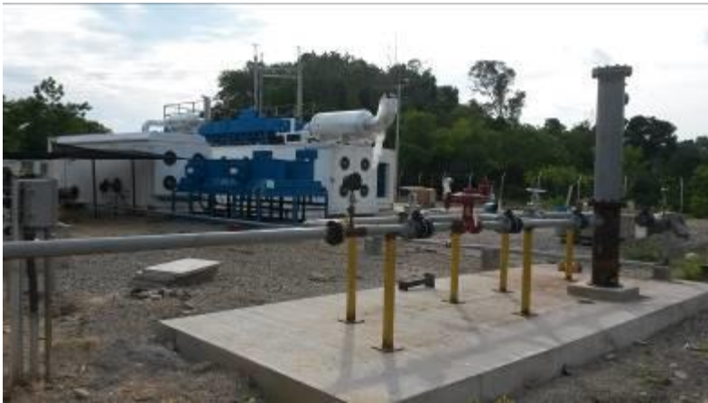
Figura 3. Válvulas de seguridad (P.S.V.)
