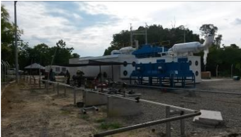
Figura 7. Pirotubos del tratador térmico
