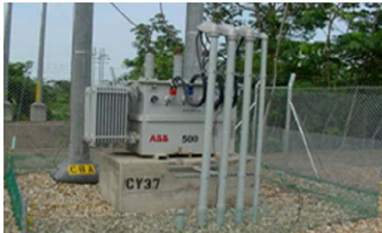
FIGURA . Transformador eléctrico
