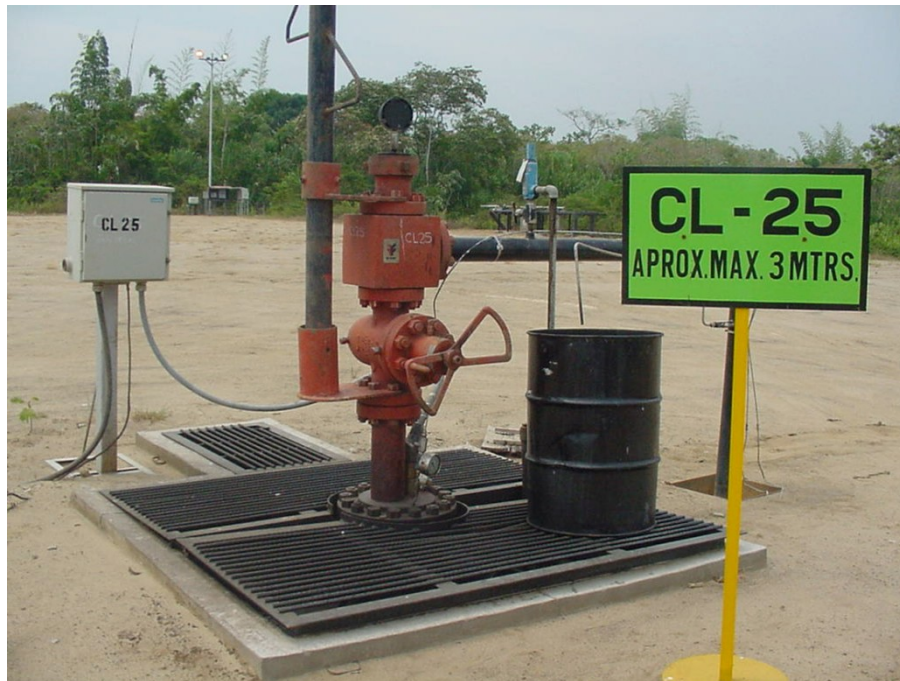
FIGURA . Cabezal de pozo
