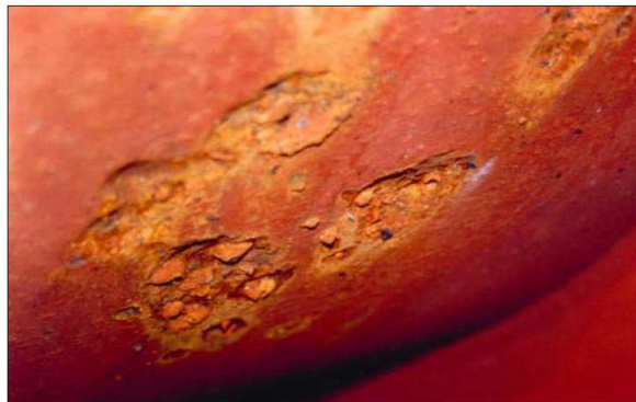
Figura 3. Corrosión en tuberías de calderas
