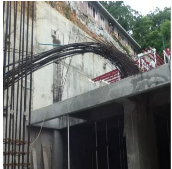
IMAGEN 12. Pandeo de acero.
