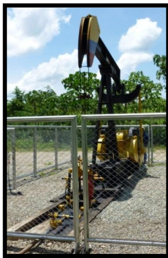
Figura 1.Unidad mecánica de levantamiento artificial Pozo 32 de CEC.
