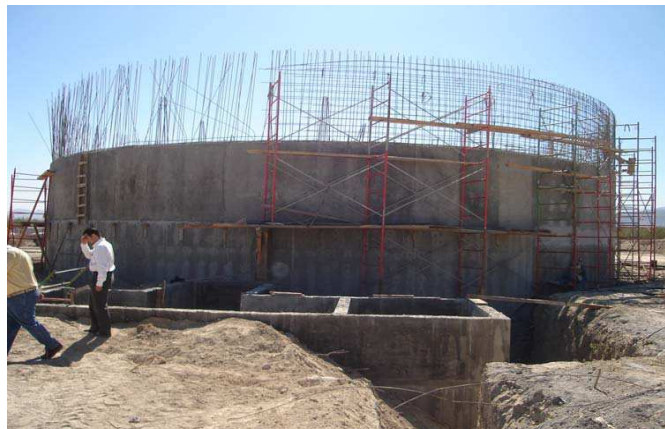
Grafica 19. Tanque de almacenamiento.
