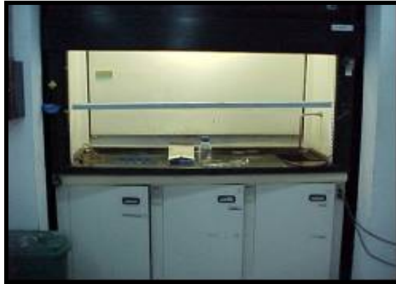
Fig. 33 Cámara de extracción de vapores
