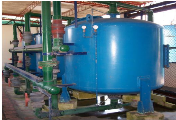
Figura 20. Filtro para el tratamiento de agua
