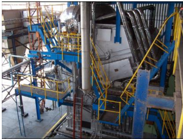
Figura 22. Caldera tipo fraser
