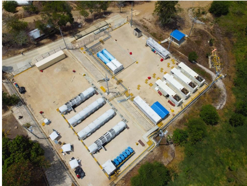
Figura 4. Instalaciones Planta GNL
