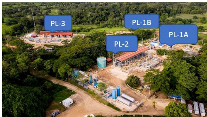
Figura 3. Instalaciones Plantas de Tratamiento Estación Jobo
