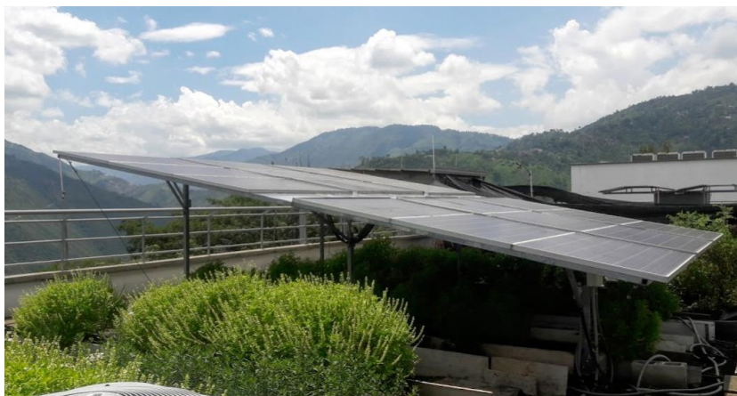
Figura 1: Sistema GRIPV, terraza superior del Edificio de Ingeniería Eléctrica
