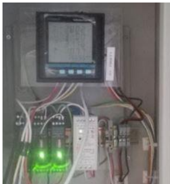
b. Acuvim instalado en la zona de tableros
