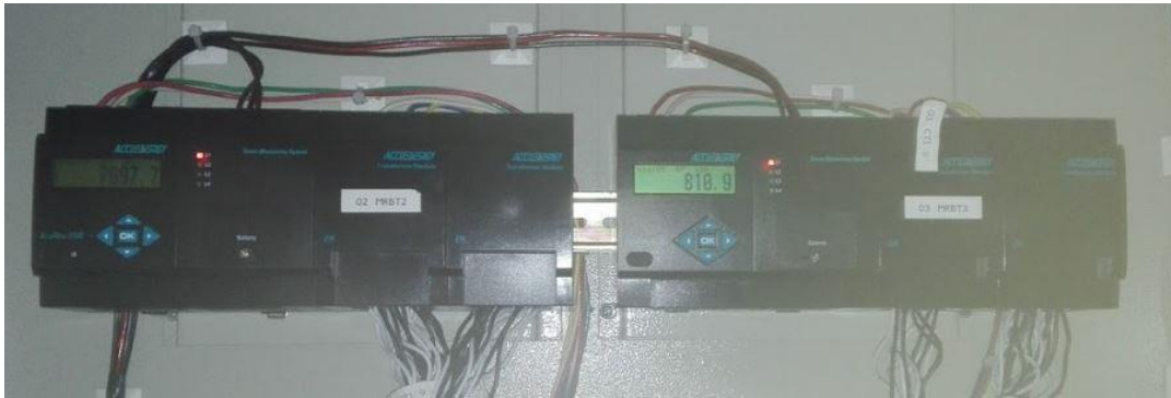
a. Equipos AcuRev instalados en la zona de tableros
