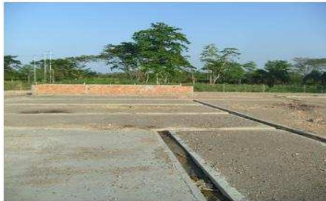
Fotografía 21. Cunetas internas en el área de la locación.
