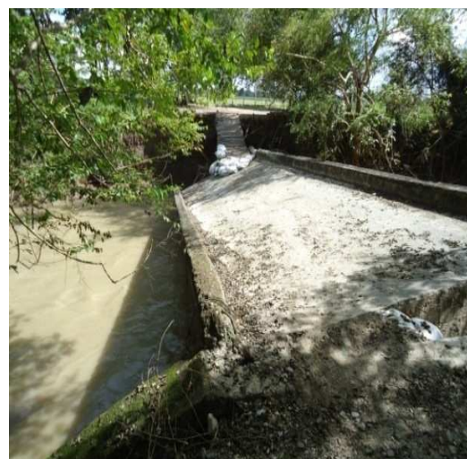
Fotografía 6 Puente colapsado sobre la Quebrada Peralonso E 1,049,117 N 1,394,898
