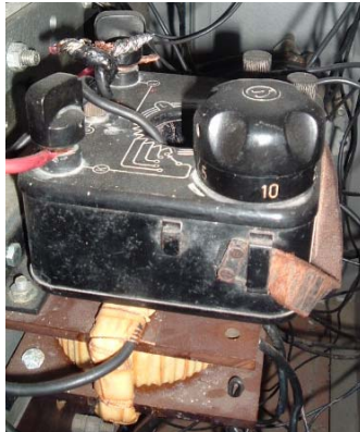
Figura 4.4 Transformador de corriente.
