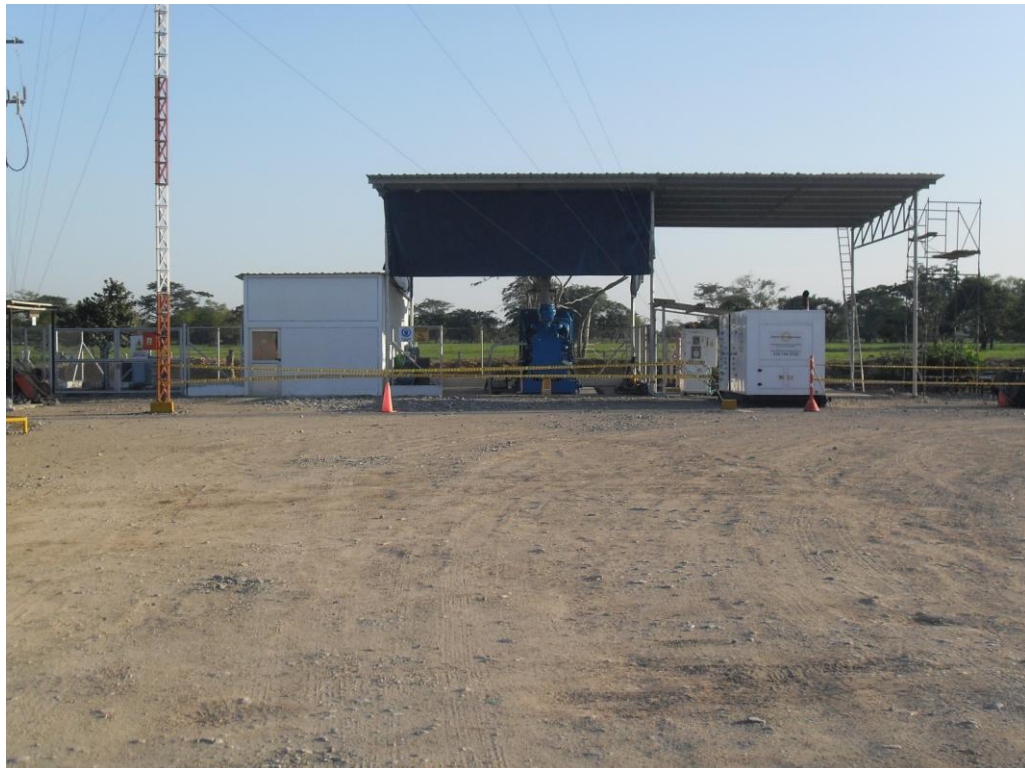
Figura No 4. Panorámica Centro de Generación
