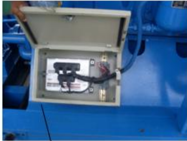
Figura No 20. Control de grupo electrógeno
