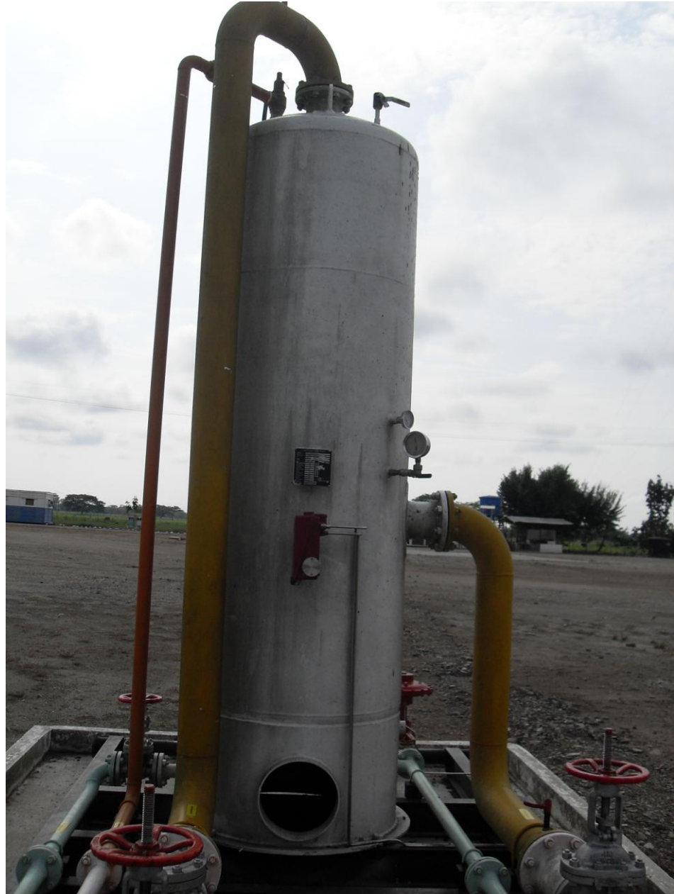
Figura No 5. Scrubber ubicado en Pozo Colon
