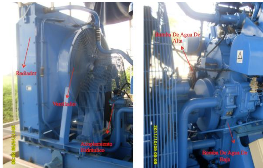
Figura No 15. Subsistema de refrigeración
