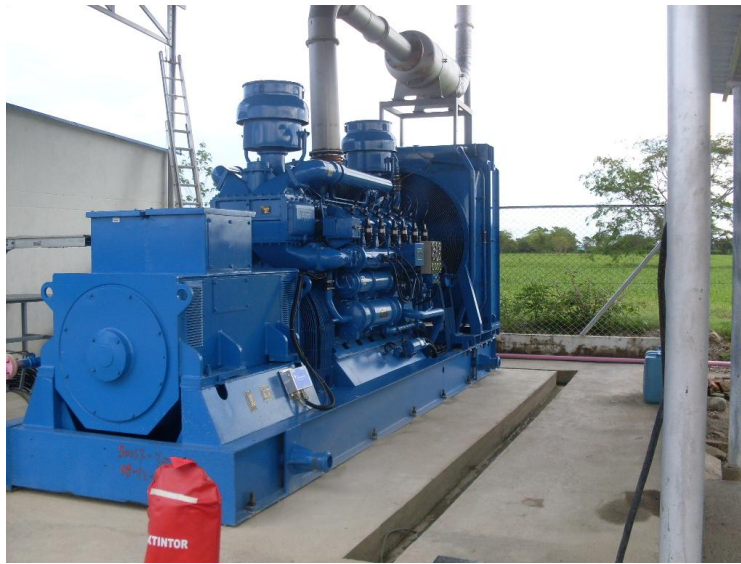
Figura No 18. Generador de 500KW
