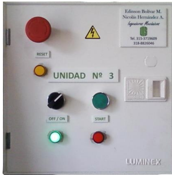
Figura 48. Tablero de control
