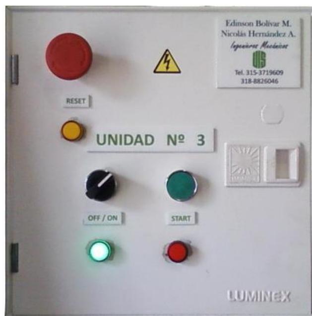
Figura 74. Tablero de control
