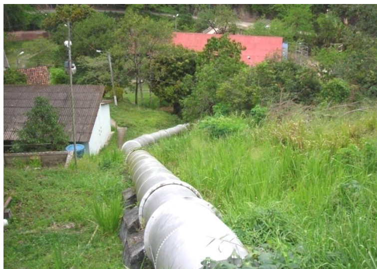
Figura 5. Tubería de presión
