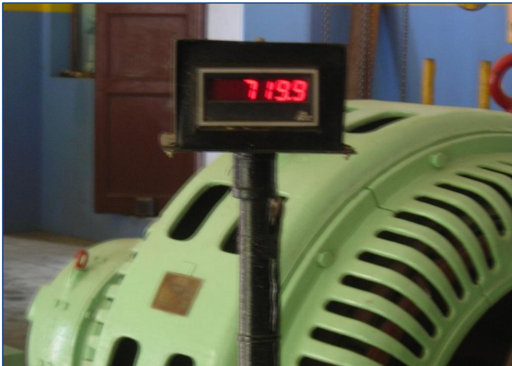
Figura 79. Tacómetro de la unidad de generación.
