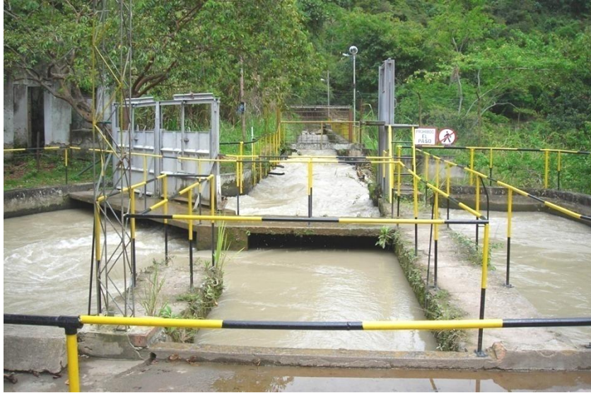
Figura 4. Tanque de presión y compuertas
