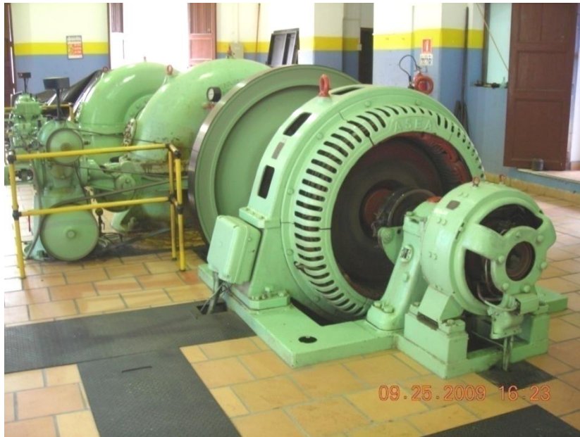
Figura 6. Casa de maquinas
