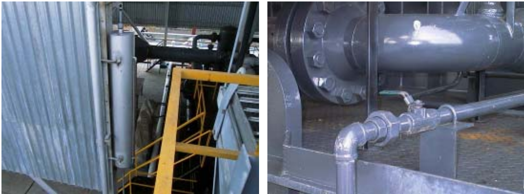
Figura 35. Se abre válvula de aceite para motor y compresor
