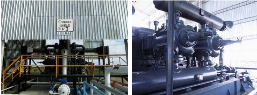
Figura 11. Unidad # 3 estación Vasconia
