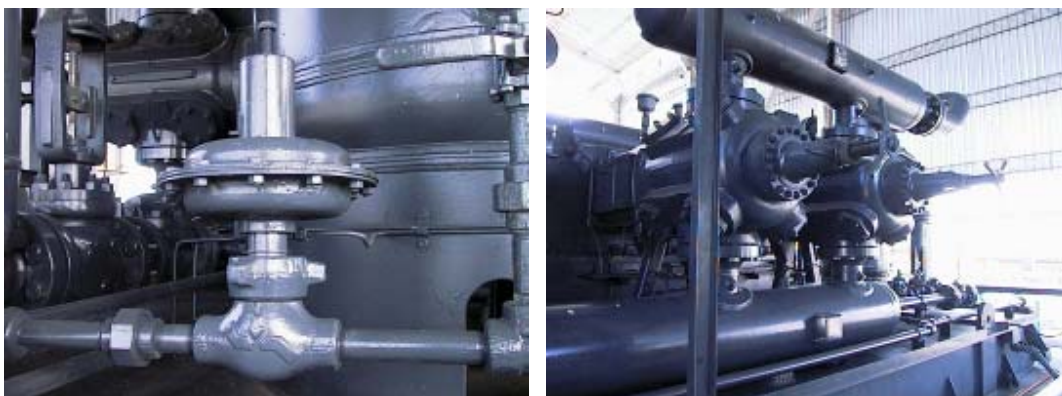
Figura 80. Válvula Neumática de Condensado (Unidad 3)
