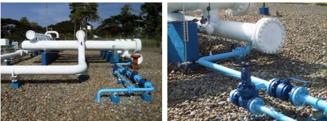
Figura 4. Slug Catcher y drenaje de condensados
