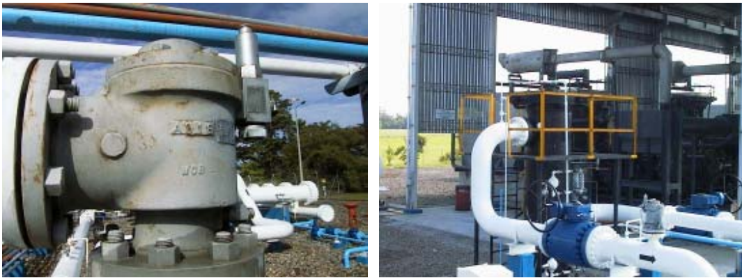
Figura 68. Válvulas de seguridad UV (Descarga)
