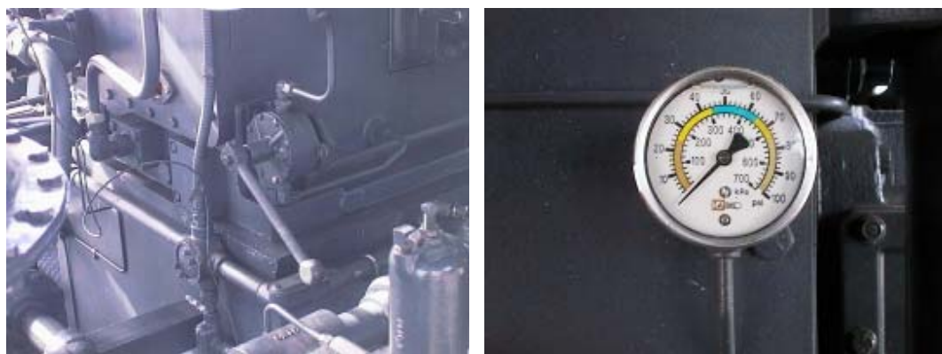
Figura 36. Prelubricación del compresor
