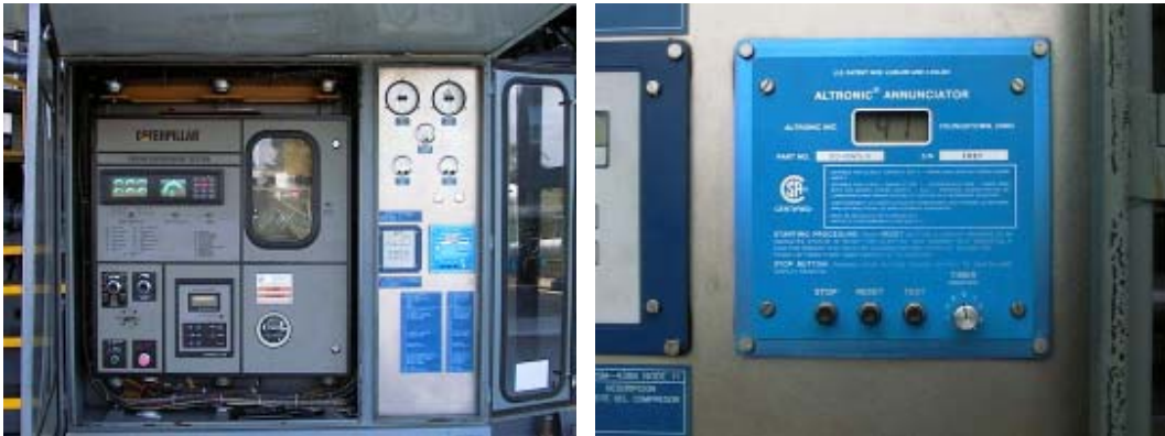
Imagen tomada en las estaciones compresoras Uniwhale de Colombia E.U.
