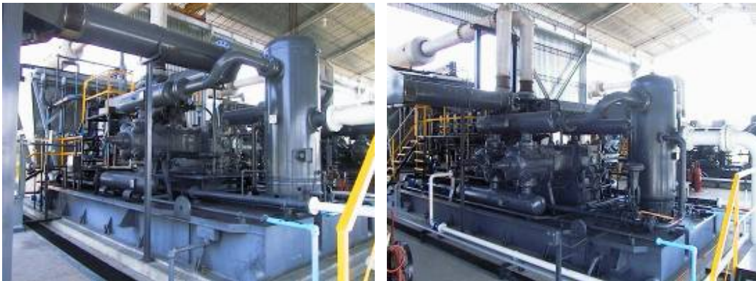
Figura 66. Revisión de la unidades compresoras
