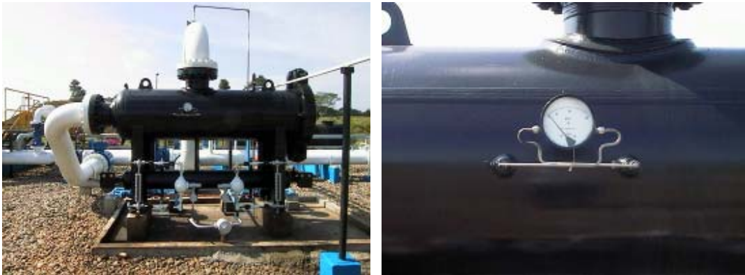
Figura 63. Presión diferencial en filtros
