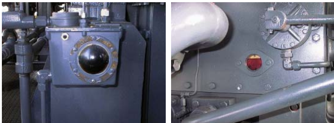
Figura 23. Niveles de aceite en motor y compresor
