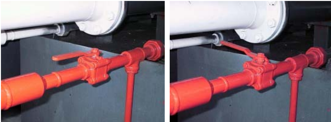
Figura 58. Se cierra válvula de aire de la unidad
