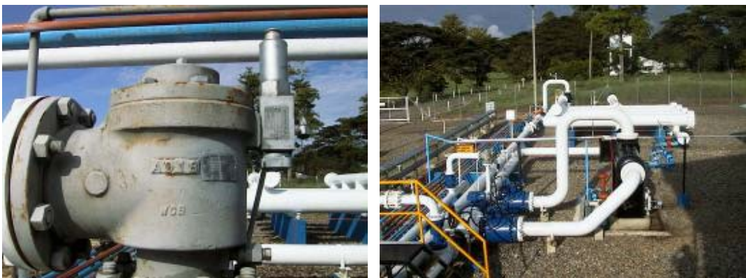
Figura 70. Válvulas de seguridad UV (Succión)
