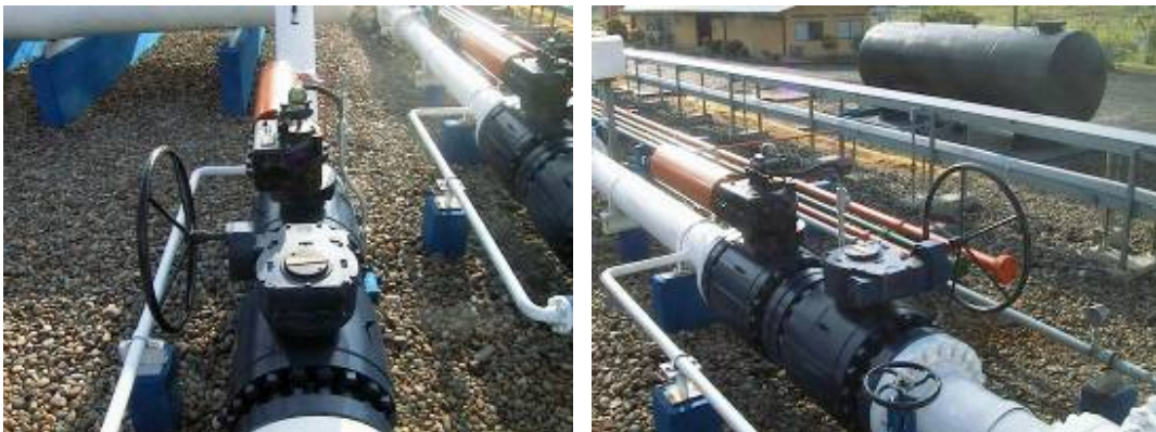
Figura 3. Válvulas principales de succión y descarga
