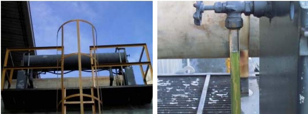
Figura 65. Niveles de refrigerante
