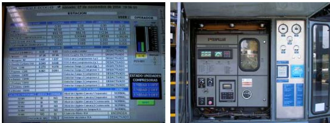
Figura 67. Datos del PLC y del panel de control de la unidad
