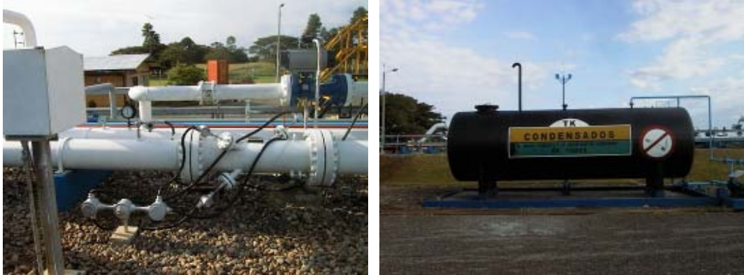
Figura 7. Medidor de Flujo Ultrasónico y tanque de condensados
