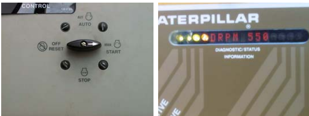
Imagen tomada en las estaciones compresoras Uniwhale de Colombia E.U.
