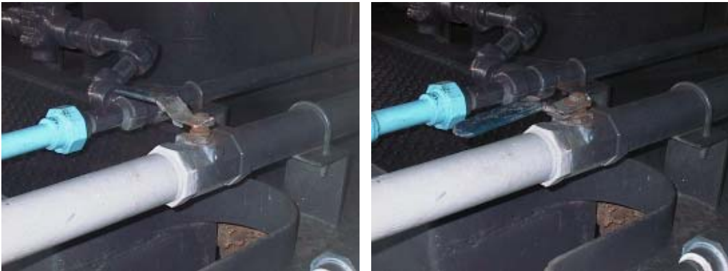
Figura 31. Se abre suministro de gas combustible al motor
