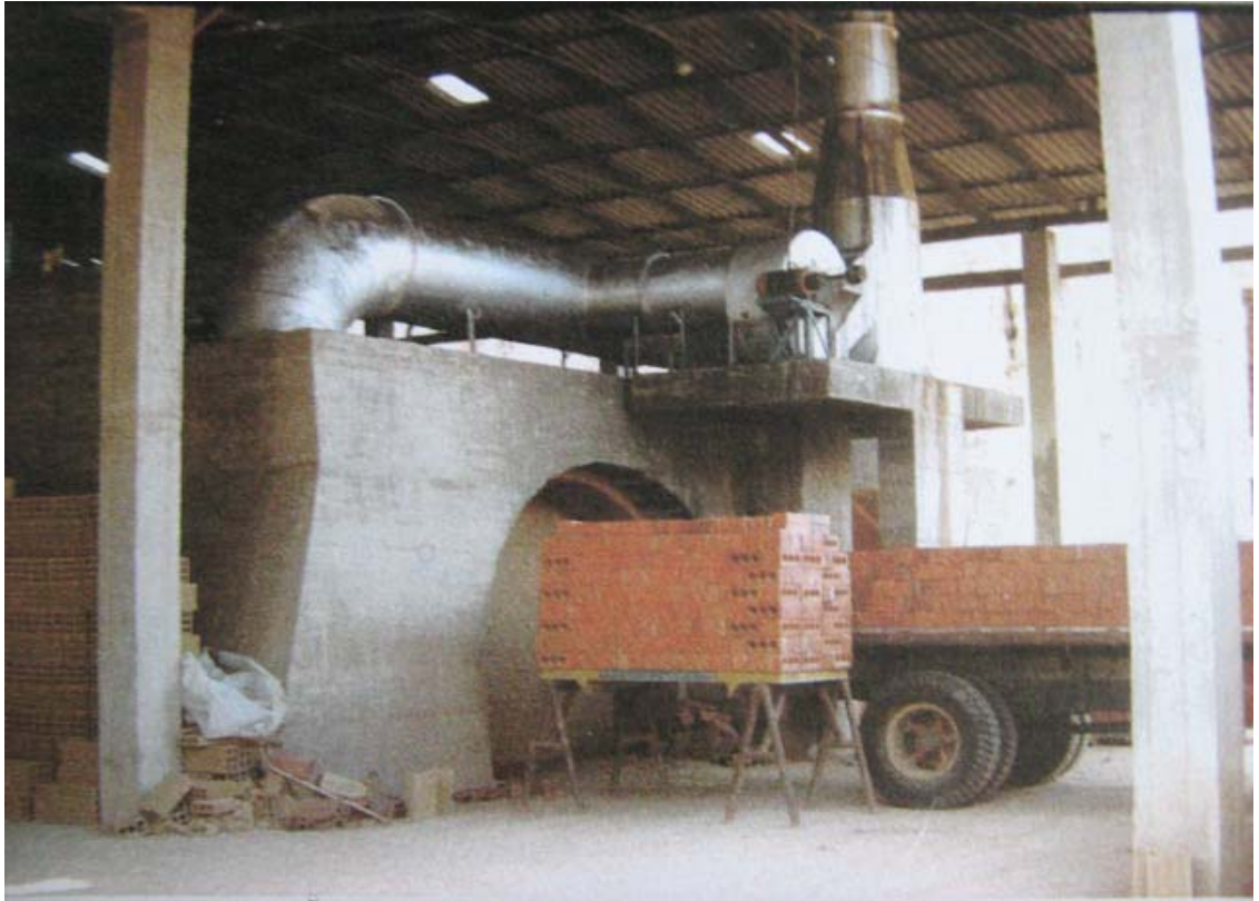
Foto 1. Horno Hoffman de alto rendimiento y eficiencia ambiental
