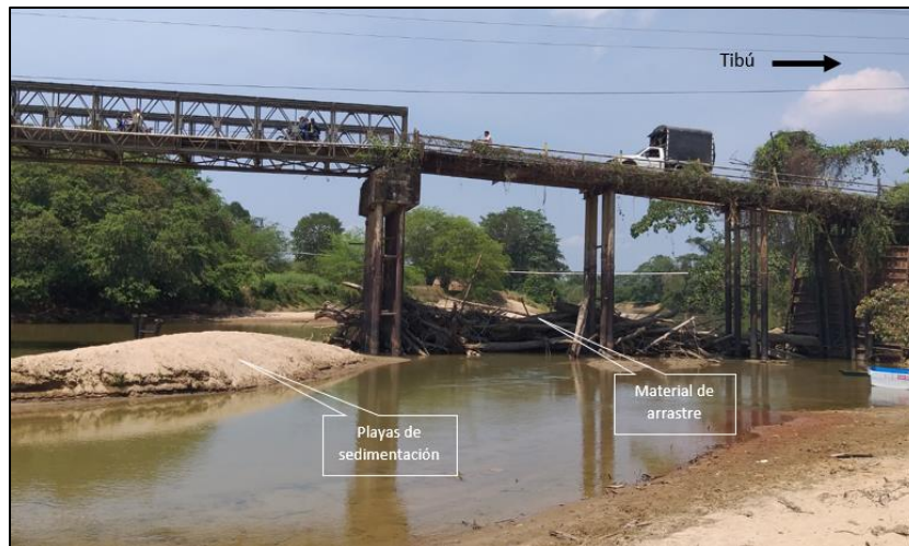
Afectaciones Localizadas sobre apoyos de rampas de acceso
