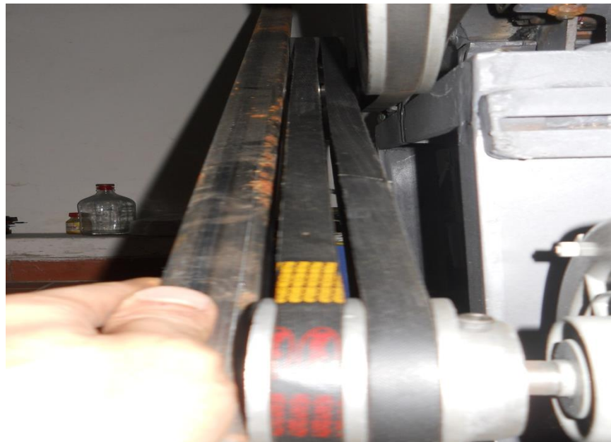
Figura 95. Alineación de la polea del motor.
